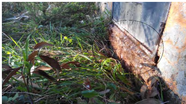
Figura 3.15 - Extravasamento do reservatório do Carapinhal Velho (Miranda do Corvo, 2014)
