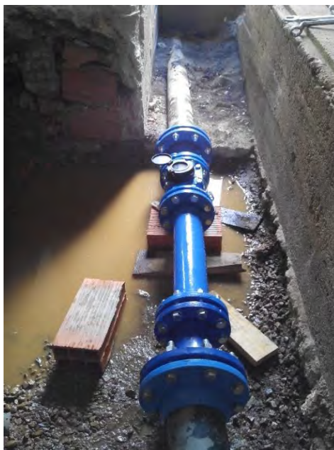
Figura 4.25 - Contador instalado a jusante do reservatório do Ribeiro
