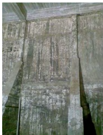
Figura 3.13 - Fissuração em Reservatório Alporcinhos (Sotecnisol, 2014)
