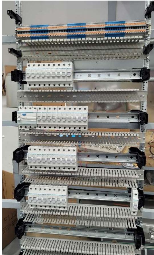
Figura 18 - Quadro com os equipamentos elétricos e calhas.
