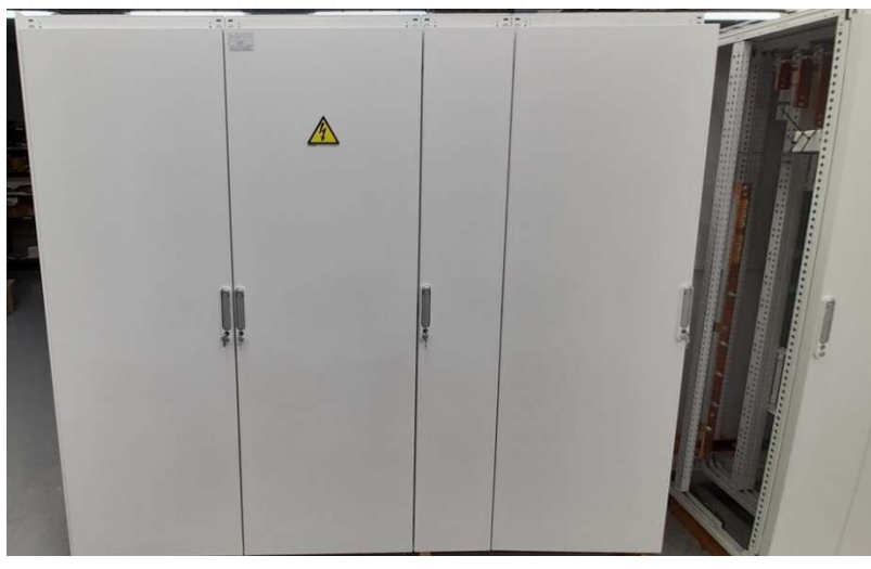
Figura 9 - QGBT de Hospital Pediátrico.
