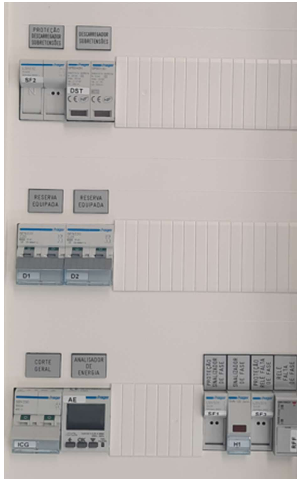
Figura 24 - Etiquetas em trafolite para identificação de equipamentos.
