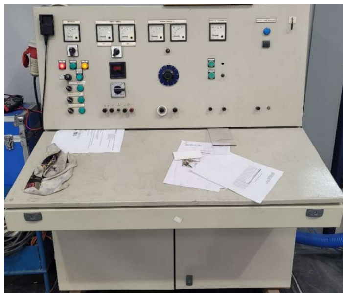
Figura 25 - Bancada de ensaios elétricos.
