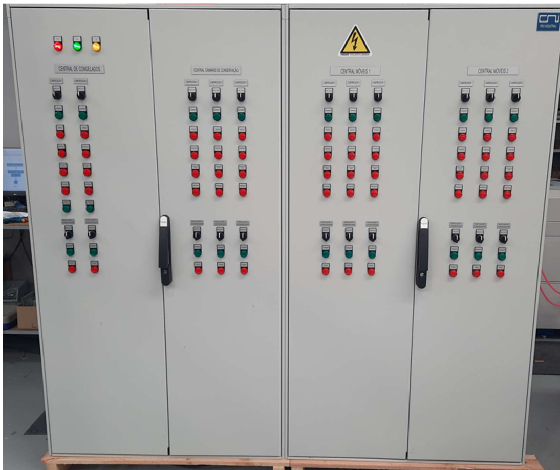
Figura 7 - Exterior de um quadro para central de congelação e ilha frigorífica
