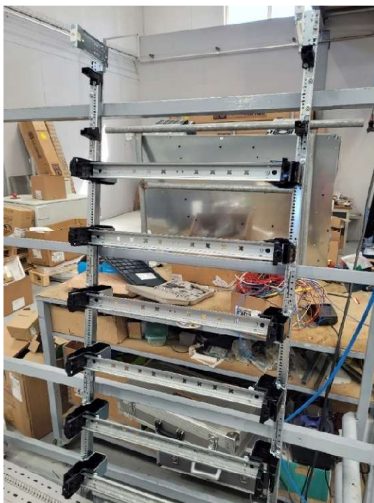
Figura 17 - Estrutura do quadro elétrico HAGER.
