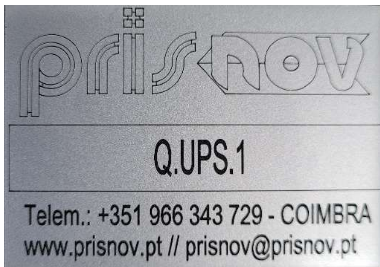
Figura 20 - Identificação Exterior do Quadro Elétrico.
