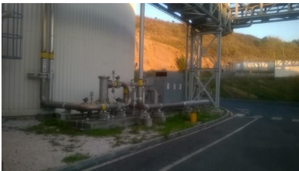
Figura 76 - Linha biogás dos digestores
