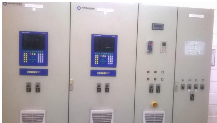
Figura 89 – Quadro comando dos motores motogeradores
