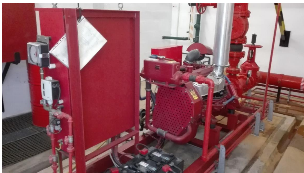
Figura 83 – Sistema de incêndios
