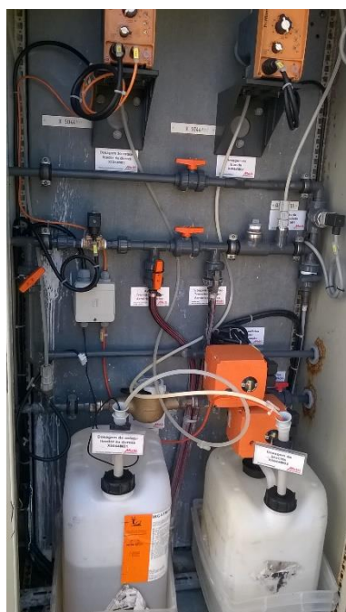
Figura 80 – Quadro Torre arrefecimento
