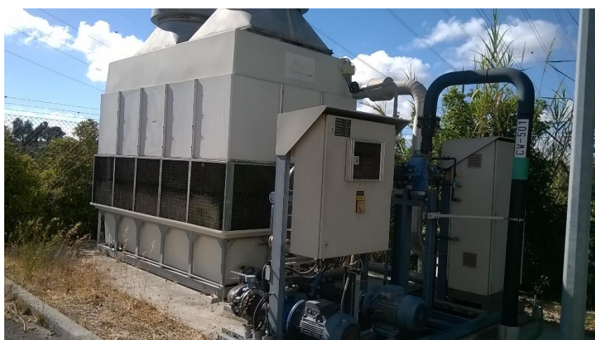
Figura 82 – Torre de arrefecimento
