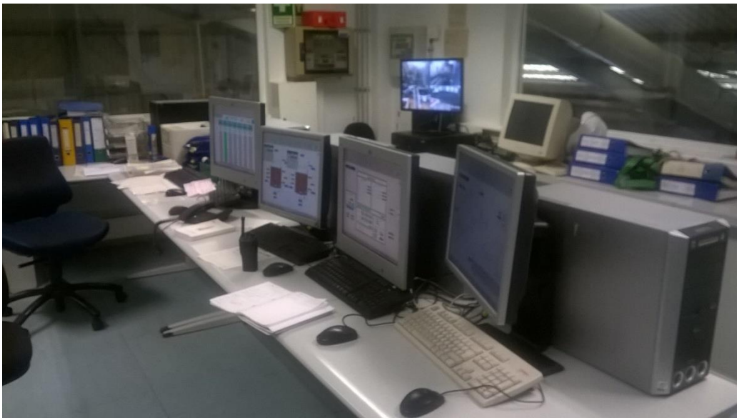
Figura 17 – Sala de Controlo
