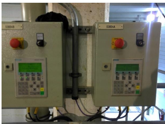
Figura 73 - PU das centrífugas S3004 A/B
