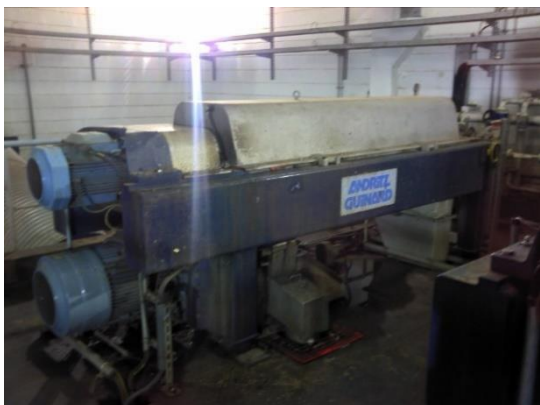
Figura 71 – Acionamento das centrífugas S3004
