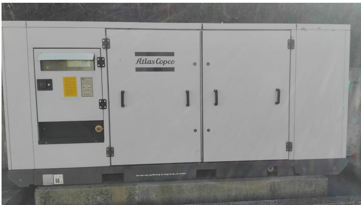
Figura 86 – Gerador de Emergência
