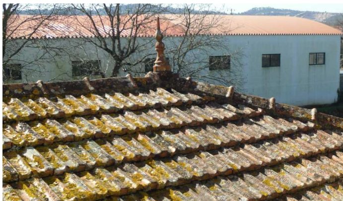
Figura 63. Telha do tipo marseille aplicada na cobertura do edifício.
