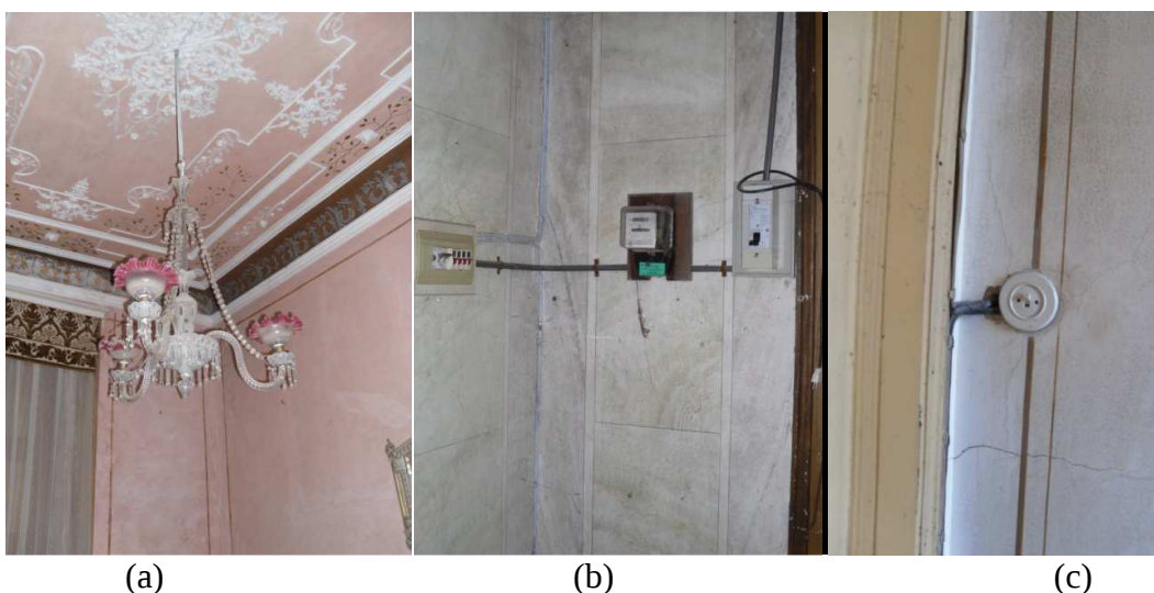
Figuras 96. (a), (b) e (c) Instalações eléctricas dos compartimentos do edifício.
