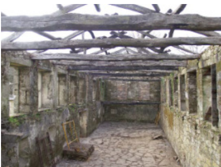
Fig. 149. Configuración estructural Curtiduría
