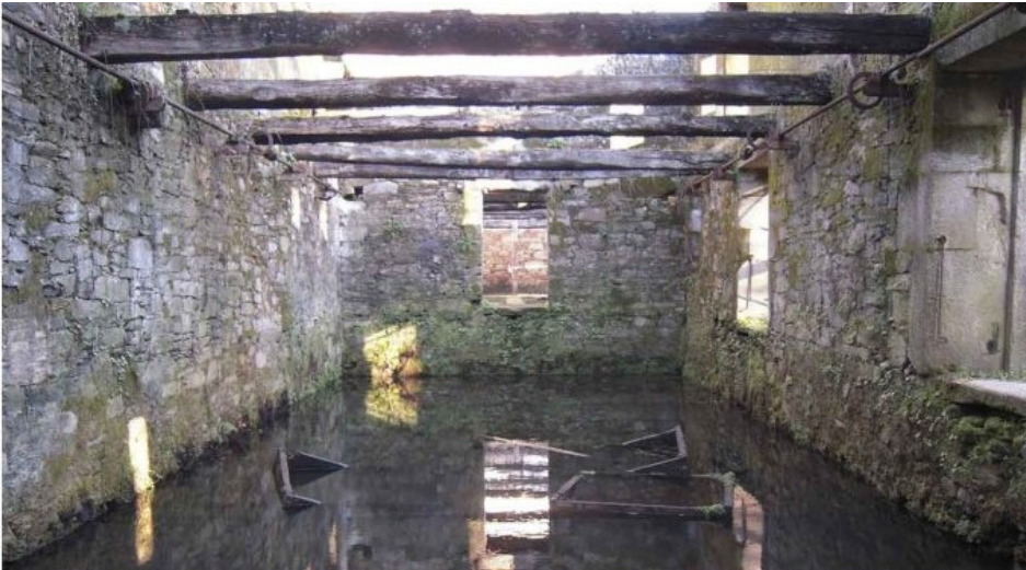
Fig. 147. Pilas inundadas antes de la intervención.
