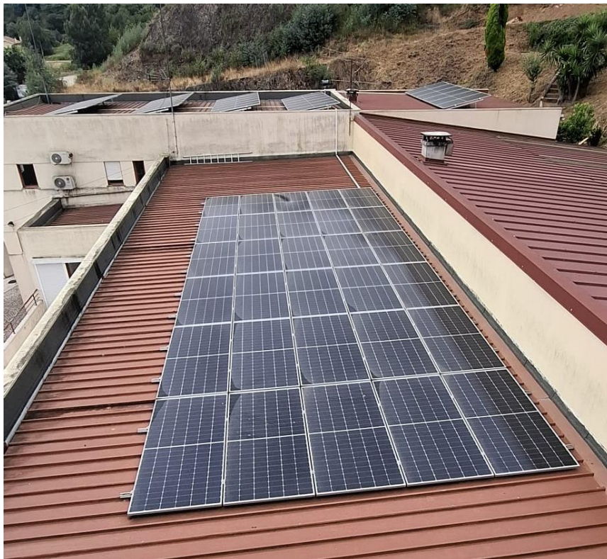
Figura 5.8 - Painéis fotovoltaicos instalados.
