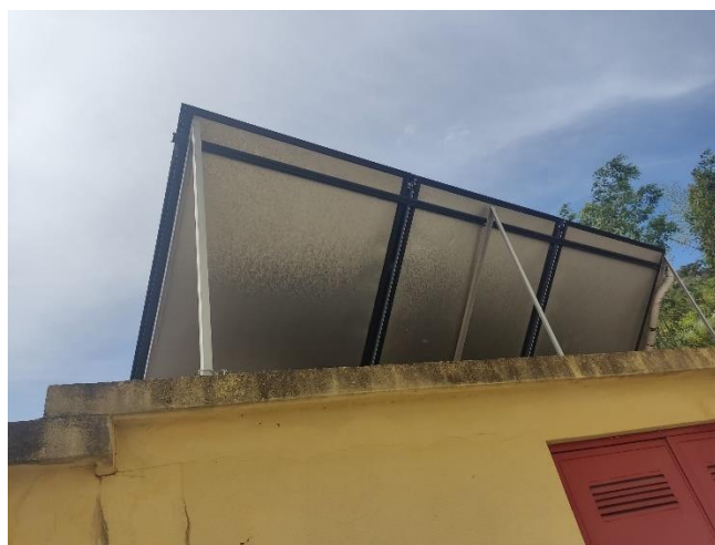
Figura 3.42 - Conjunto de coletores solares V26P.
