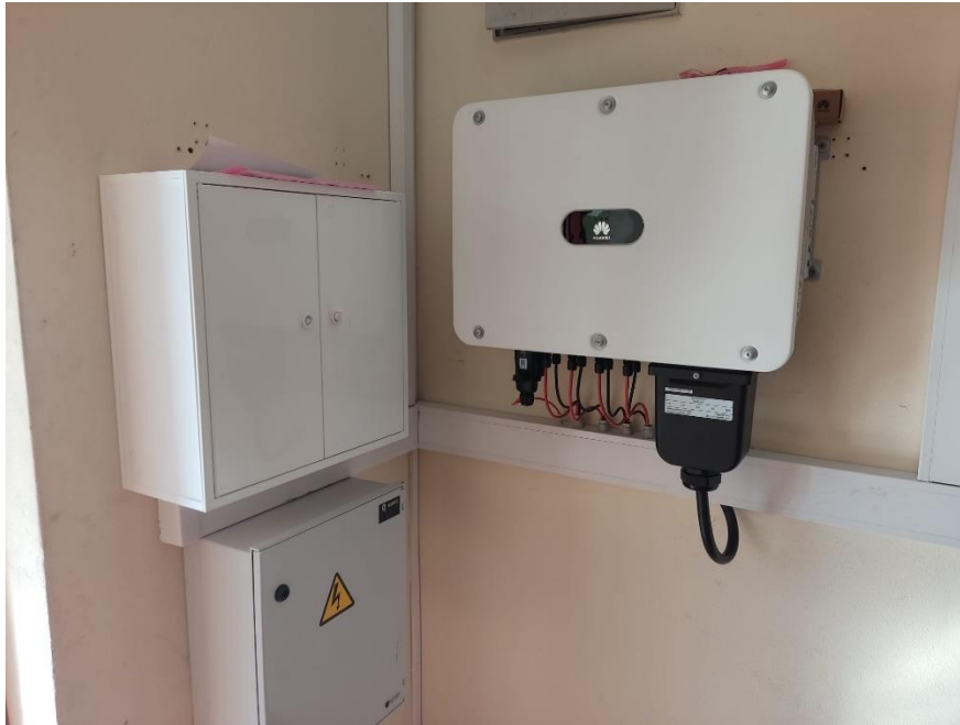
Figura 5.7 - Inversor fotovoltaico instalado.
