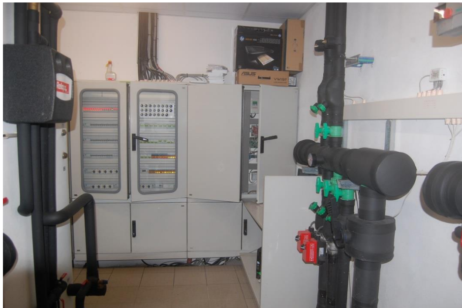
Figura 52- Foto da Central Térmica II
