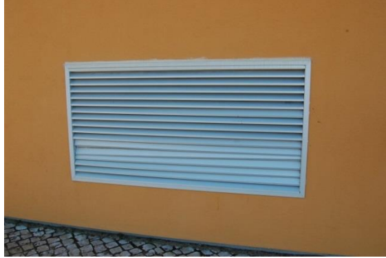
Figura 26- Foto das grelhas de ventilação exterior
