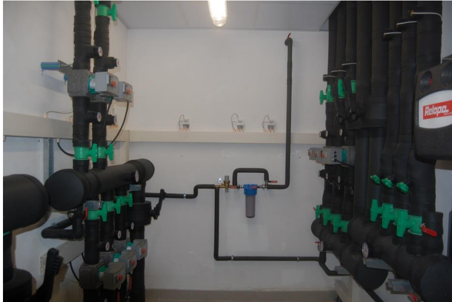
Figura 51- Foto da Central Térmica
