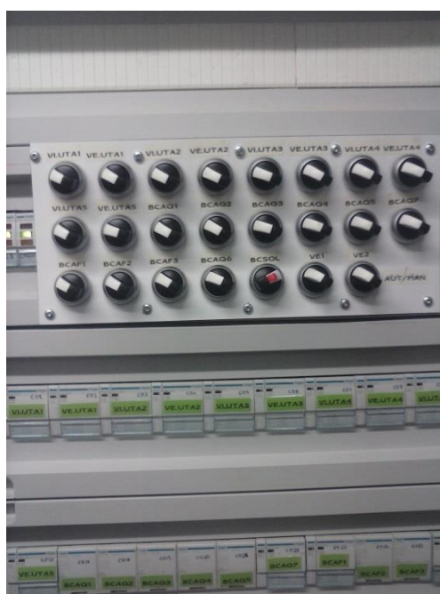
Figura 48- Imagens do controlador manual do AVAC
