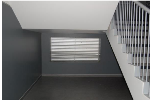
Figura 27- Foto das grelhas de ventilação interior
