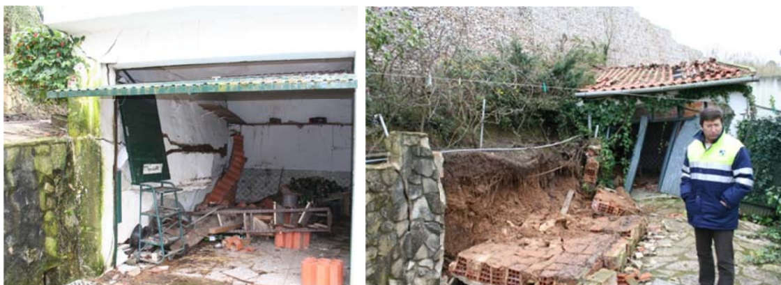
Figura 3.2 – Imagens da zona de base do talude em Fevereiro de 2010.
