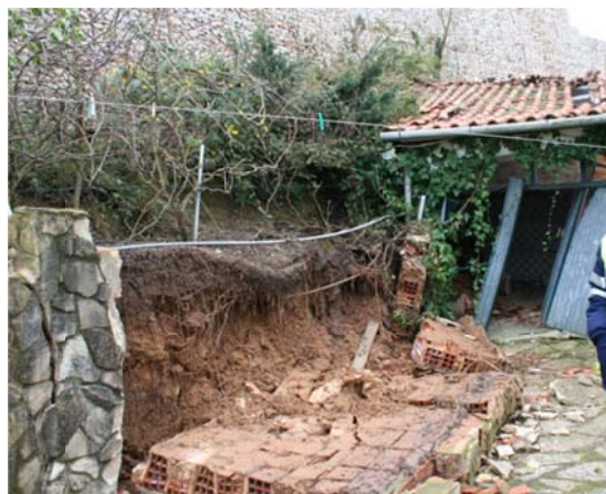
Figura 1.4 - Imagem da base do talude da auto-estrada A8 ao KM 92+600, no dia 9 Fevereiro 2010.
