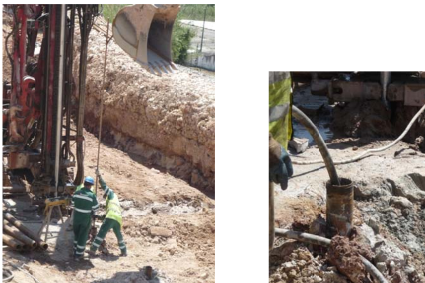
Figura 3.41 – Colocação da armadura (esquerda) e de calda de cimento por gravidade (direita), na microestaca.
