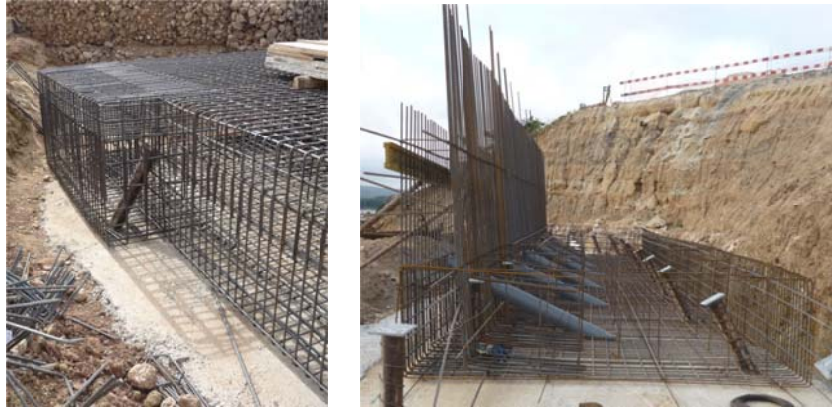
Figura 3.46 – Pormenor da variação de largura da sapata e de disposição dos varões.
