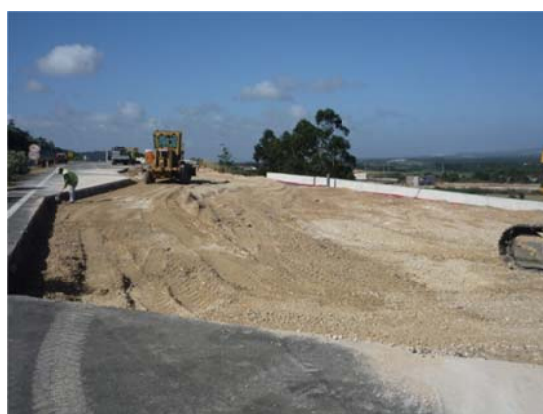
Figura 3.69 – Remoção parcial da faixa de rodagem na zona dos trabalhos de estabilização.
