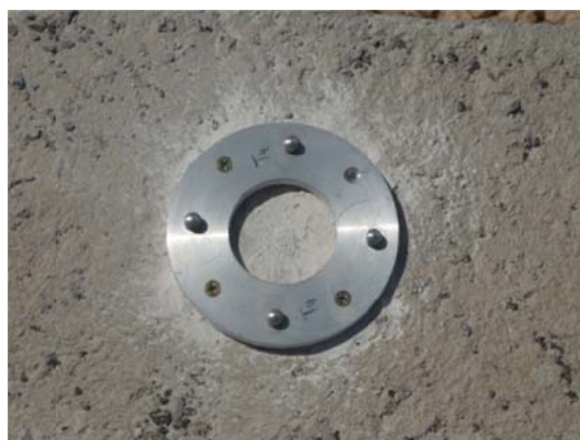
Figura 4.3 - Base de um clinómetro instalado no muro em “L” de betão armado.
