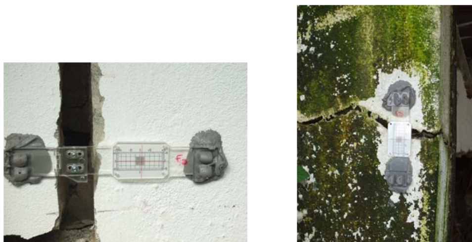
Figura 4.7 – Fissurómetros F2 (esquerda) e F3 (direita)
