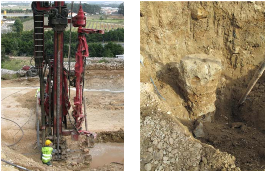
Figura 3.34 - Execução de colunas de ensaio da zona 2 (esquerda) e posterior escavação (direita).
