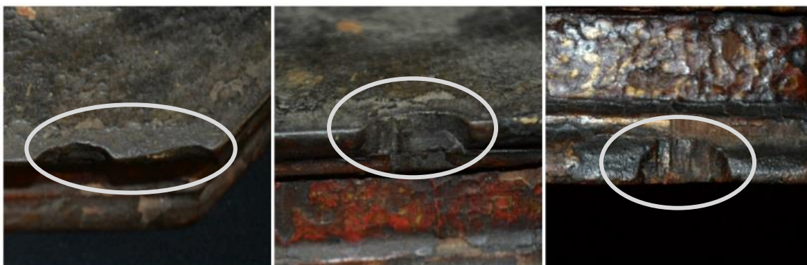
Fig. 27 – Lacunas ao nível do suporte: Pormenores onde se observam lacunas ao nível da estrutura na base, no friso superior, vista picada de uma lacuna na frente; vista frontal da mesma lacuna; e vista frontal de uma lacuna no friso inferior, vista lateral esquerda. Fonte: de elaboração própria.
