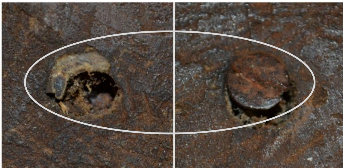
Fig. 30 – Elementos metálicos oxidados e corroídos: Pormenor dos pregos aplicados pela parte inferior da base para reforçar a união entre a imagem e a base depois de fraturada (vista inferior da base). Fonte: de elaboração própria.
