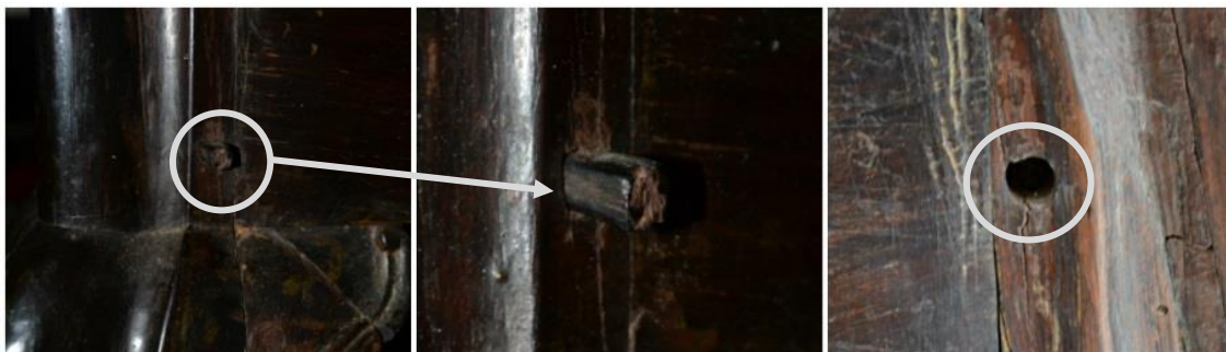
Fig. 94 – Perda de elementos de travamento das ligações: Pormenores das cavilhas salientes e perda de uma área onde já se perdeu a cavilha. Fonte: de elaboração própria.
