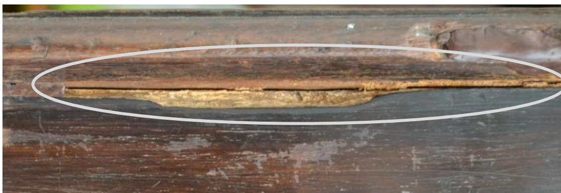
Fig. 91 – Vestígios de actividade biológica: Pormenor onde se observa uma lacuna por acção de insectos xilófagos. Fonte: de elaboração própria.
