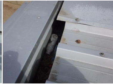
Figura 4.62 - Nível 3 - Escola básica Alto da Faia - caleira de cobertura inclinada da casa das máquinas
