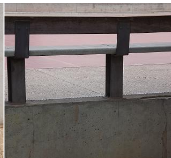
Figura 4.50 - Nível 3 - Escola básica Alto da Faia - banco do campo de jogos junto a muro, falta de segurança
