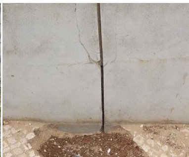
Figura 4.49 - Nível 2 - Escola básica alto da faia - junta de dilatação no muro exterior, provoca infiltrações
