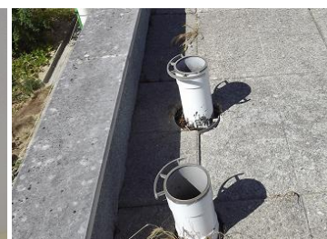
Figura 4.53 - Nível 3 - Escola básica Alta de Lisboa - chaminés das cozinhas sem tampa
