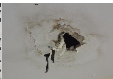
Figura 4.52 - Nível 2 - Escola básica Alta de Lisboa - abertura destinada a iluminação deixada vazia
