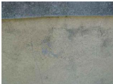
Figura 4.15 - Nível 1 - Escola Secundária Gil Vicente – reboco pintado em muro de betão (Marques, 2012)
