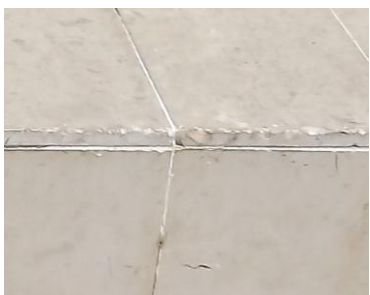
Figura 4.42 - Nível 1 - Escola básica Alto da Faia - lancil do pavimento exterior da entrada principal
