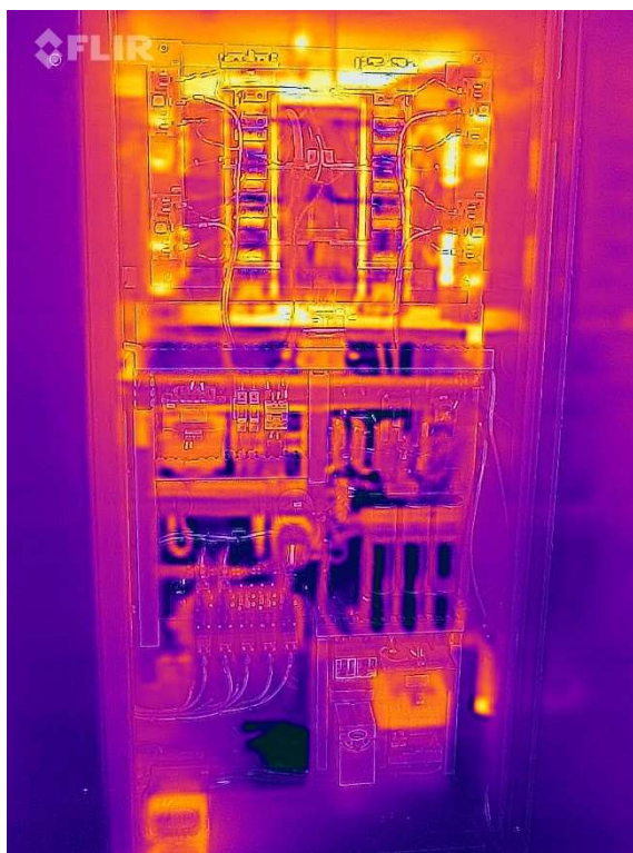
Figura 51 - Imagem termográfica do quadro elétrico 2
