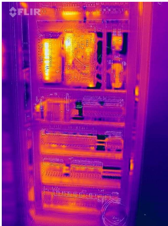
Figura 50 - Imagem termográfica do quadro elétrico 1
