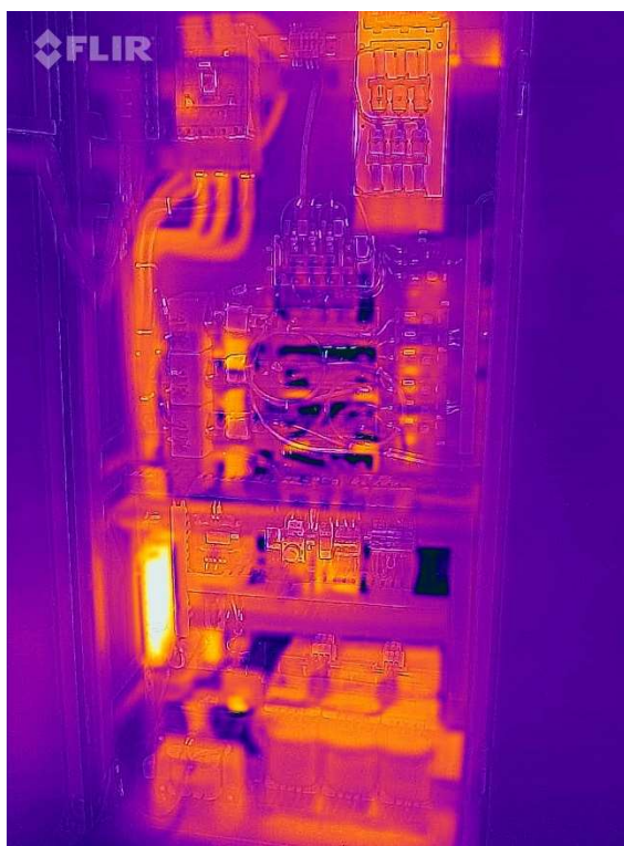
Figura 52 - Imagem termográfica do quadro elétrico 3
