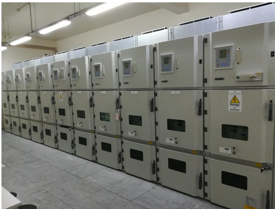
Figura 4.7 - QDMT instalado na Celbi.
