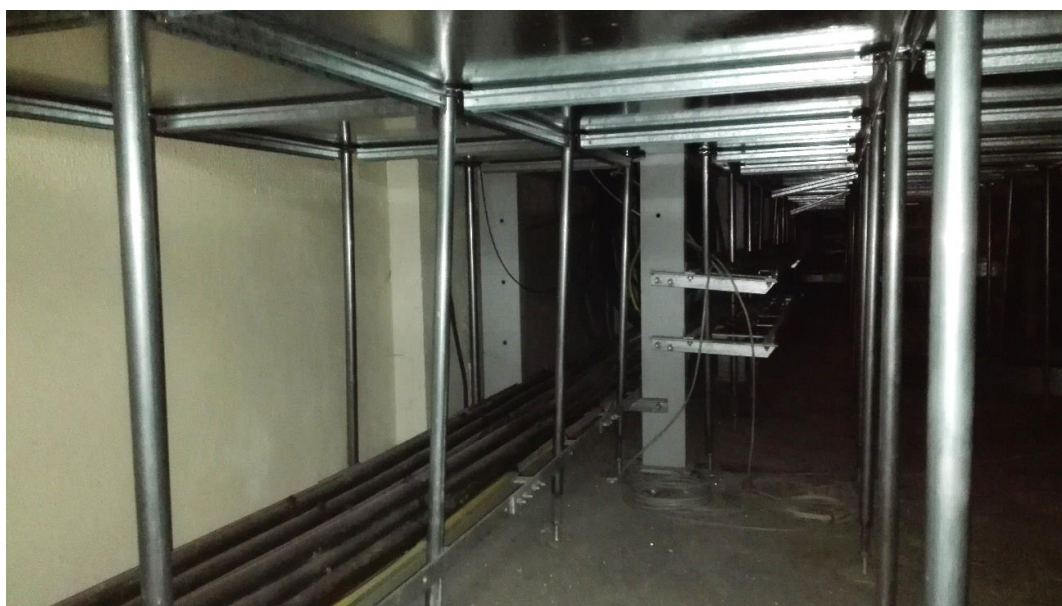
Figura 3.28 - Piso técnico da sala de quadro.
