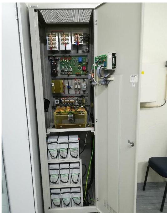
Figura 4.8 - Carregador de baterias e banco de baterias.
