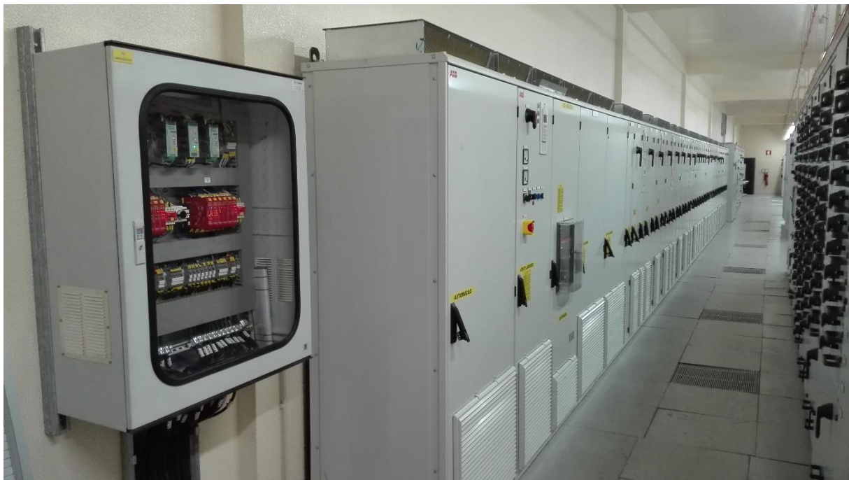
Figura 3.31 - Vista do painel =92 e Multidrive.
