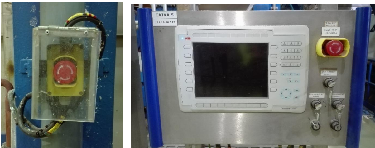
Figura 3.4 - Botoneiras de emergência.
