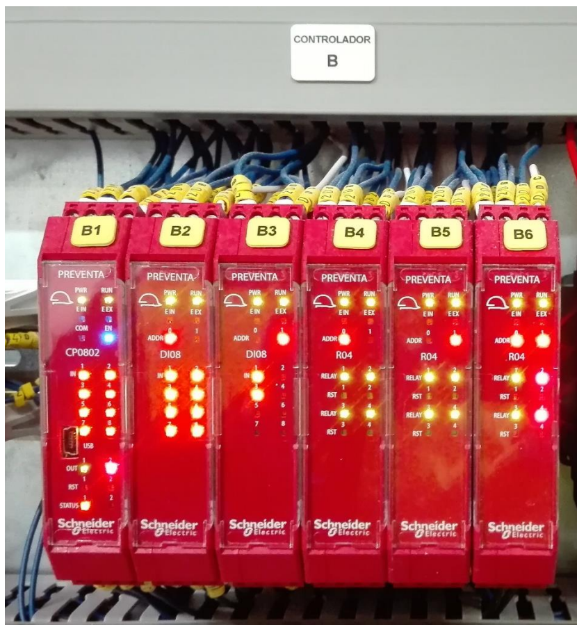
Figura A7.1 - Controlador B.
