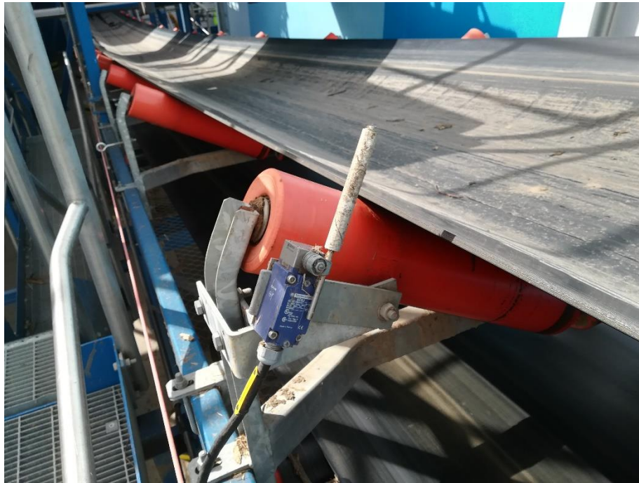
Figura 4.14 - Sensor de desvio de tela instalado na L6.
