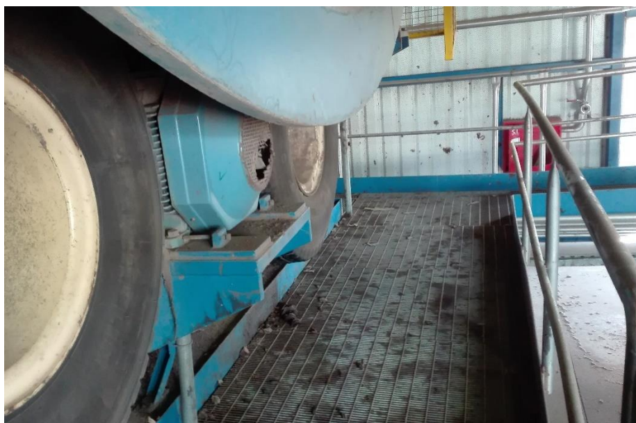
Figura 4.10 - Proteção do ventilador degradada.
