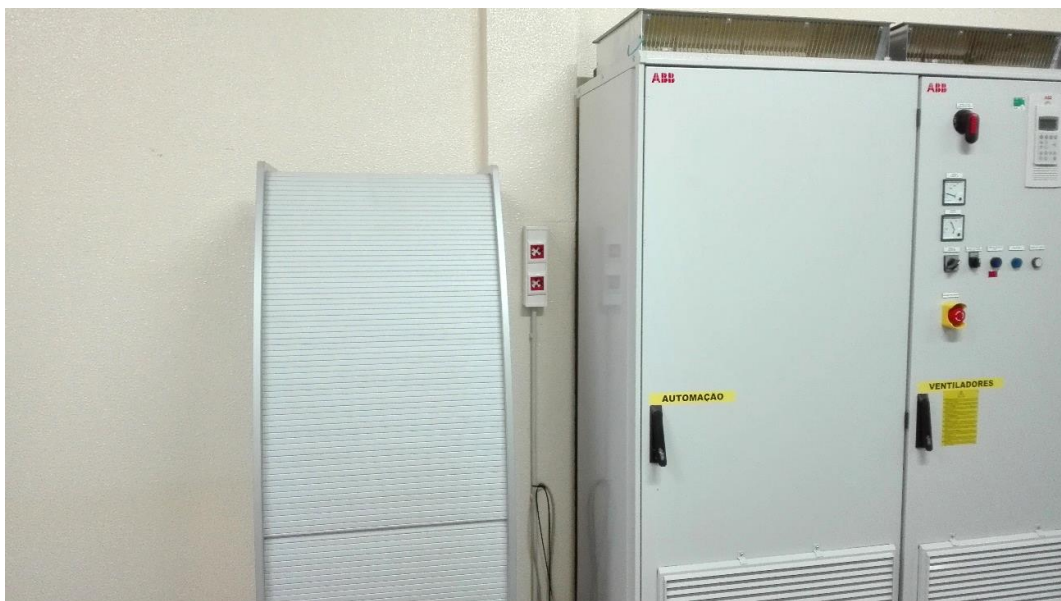
Figura 3.26 - Localização para painel =92 antes de instalado.
