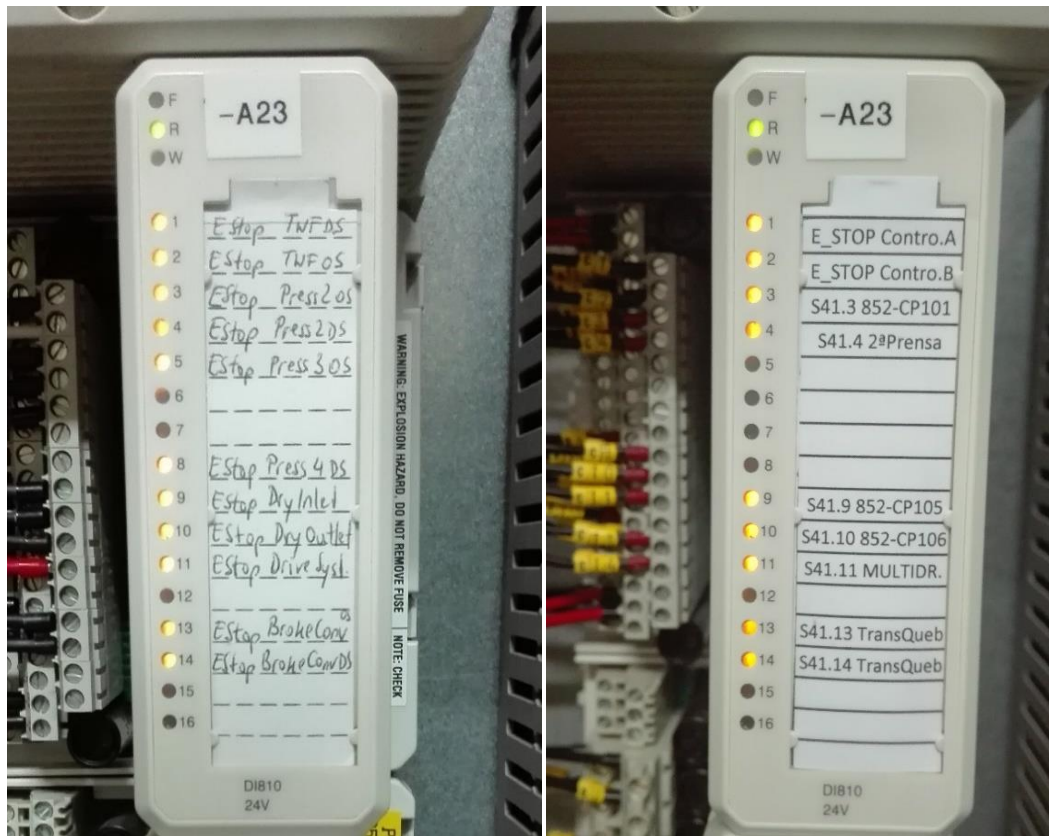
Figura 3.32 - Label do módulo de DI A23 antes e após a reconversão do SPE.
