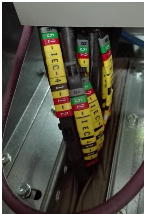
Figura 3.17 - Cabos à entrada do armário =91.
