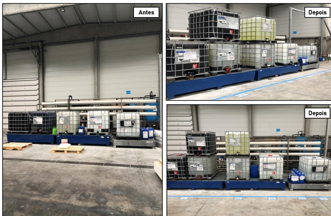
Figura 18 – Zona de armazenamento dos materiais da ETA utilizados com maior frequência
