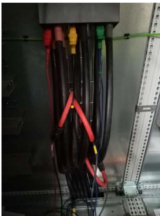
Figura 14 – Medições no quadro elétrico
