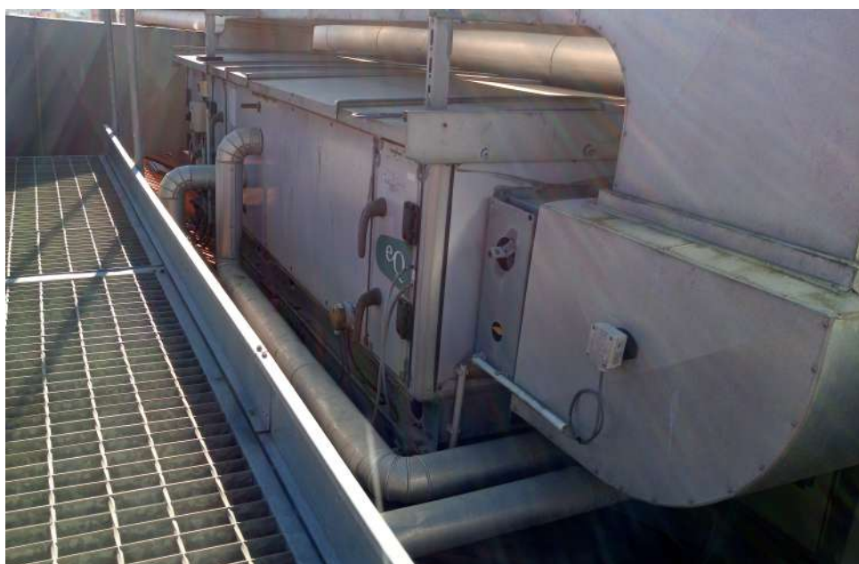
Figura 15 - Unidade de tratamento de ar
