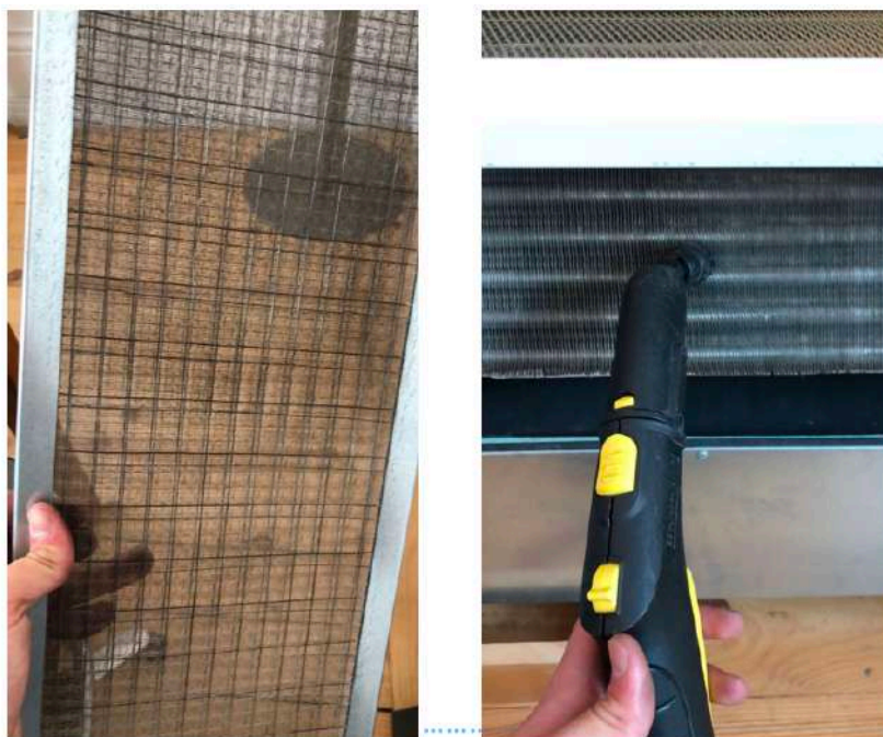
Figura 25 - Limpeza e desinfeção dos filtros e baterias de sistemas de ar condicionado
