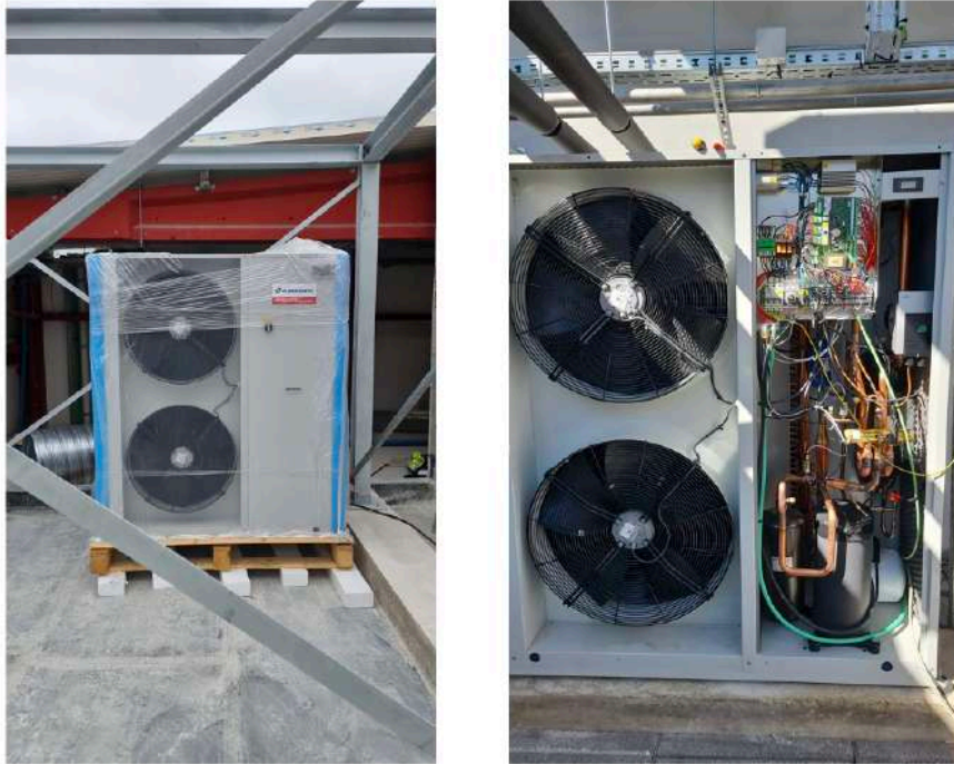
Figura 18 - Bomba de calor
