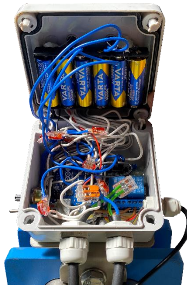
Figura 6.10 - Automação montada na caixa estanque
