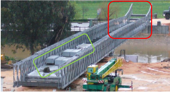
Figura 31 - Montagem de uma ponte Mabey utilizando contrapesos em Odeira (Companhia de Pontes, 2011)
