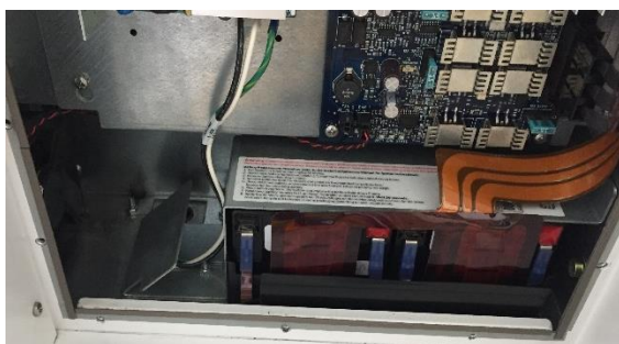
Figura 47 - Baterias do ventilador S/5 Avance.
