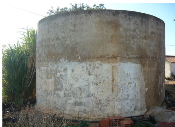
Figura 34 - Depósito de água
