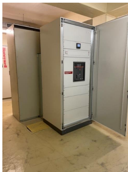
Figura 22 – Coluna de interligação do QGPV2 ao quadro elétrico existente
