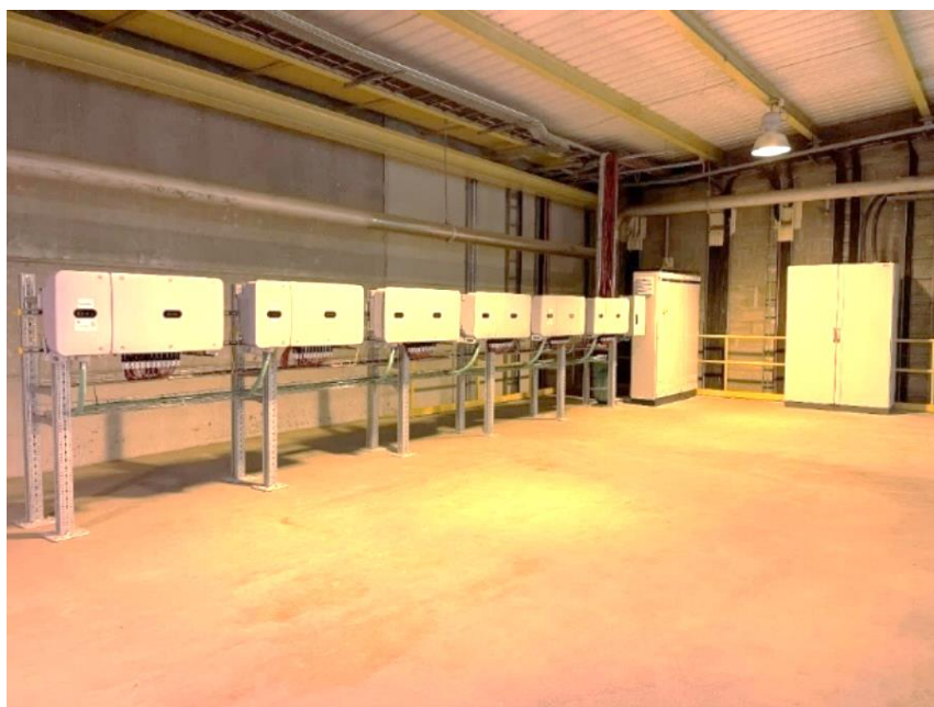
Figura 13 – Quadro QGPV1 com os 6 inversores
