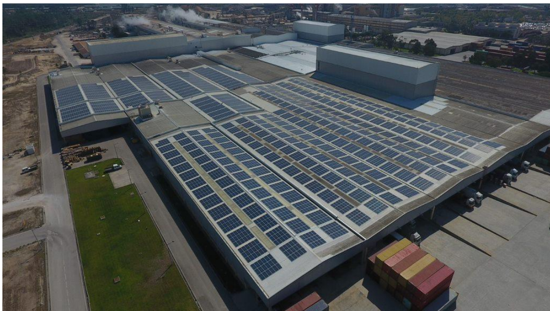
Figura 10 – Central fotovoltaica com 7700 painéis na NVG – Figueira da Foz
