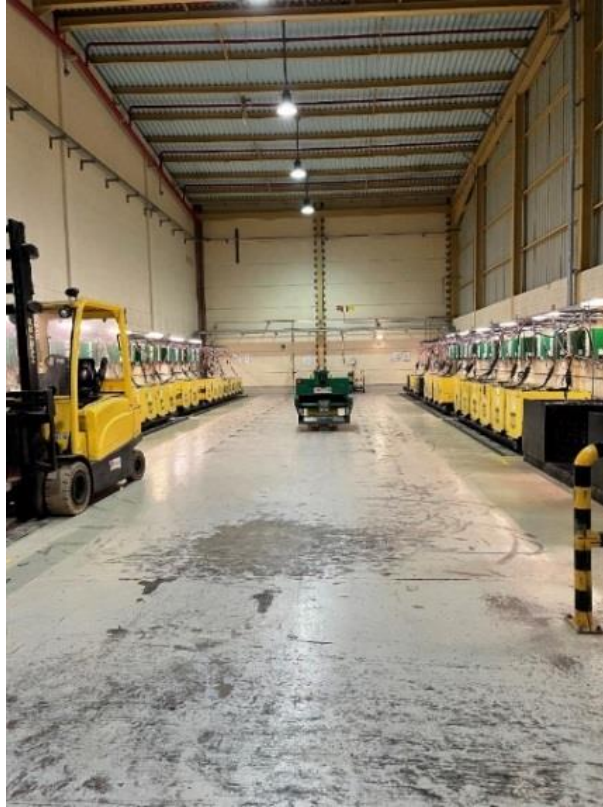
Figura 40 – Sala de carregadores de baterias dos empilhadores
