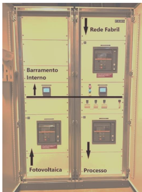
Figura 14 – Armário elétrico com 2 fontes de tensão – interligação QGPV1
