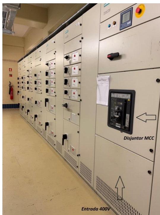
Figura 17 – Vista frontal da alimentação ao quadro fabril
