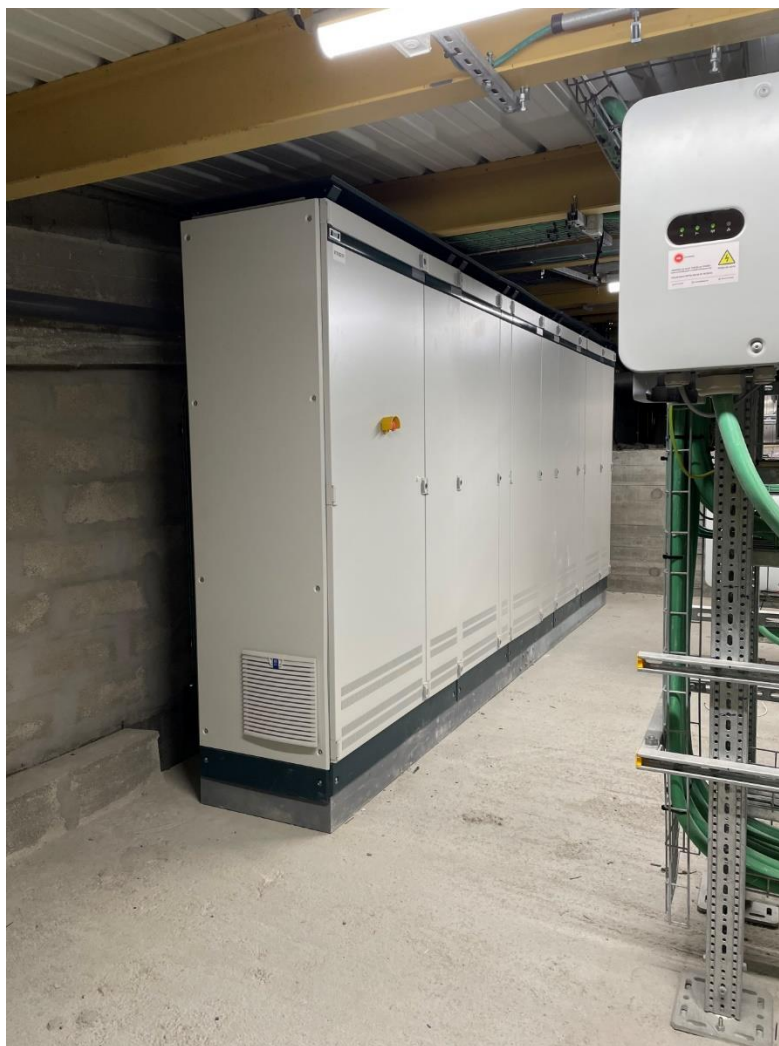
Figura 15 – Quadro QGPV2 (ligação dos inversores e saída para quadro interligação)
