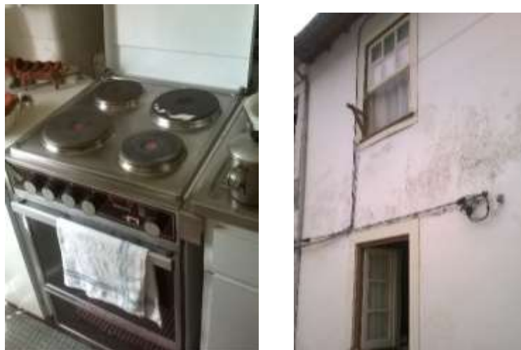
Figura 4.3 – Edifício que recorre à eletricidade (em vez de gás); Instalações elétricas nas fachadas
