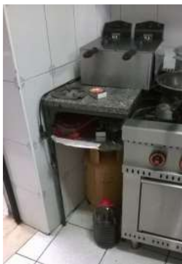
Figura 4.5 – Localização das garrafas de gás na cozinha, junto do fogão
