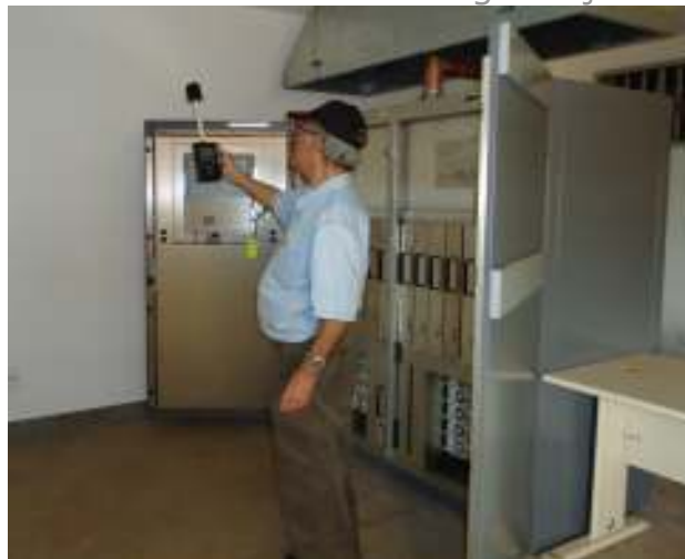
Figura 4 – Medição na sala do transmissor
