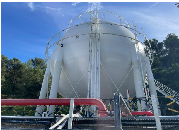
Figura 12- Esfera de GPL nº3, Instalação da Banática. Fonte: foto do autor
