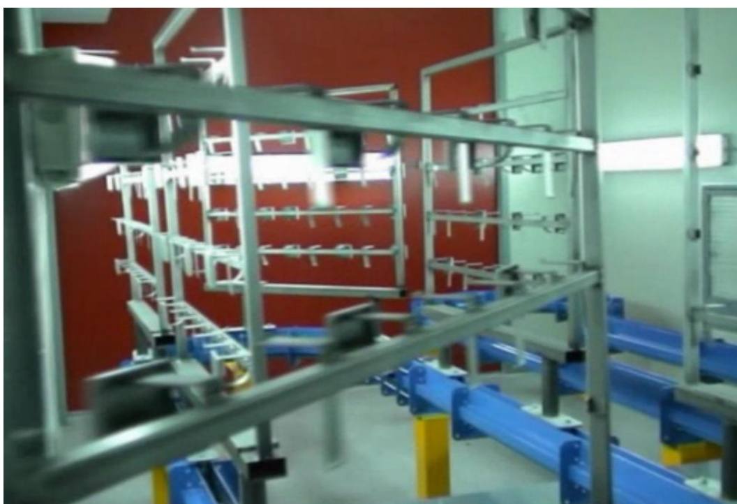
Figura 4. 7 - Estufa de secagem da linha de pintura automática.
