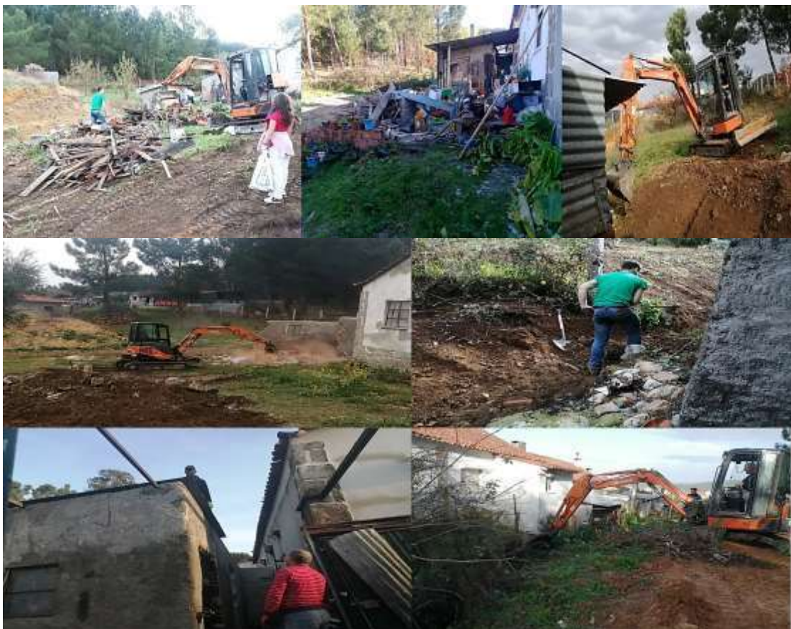
Figuras 112 a 118 – Fotografias da Atividade “Demolição de Barracões e Limpeza da Barroca”
