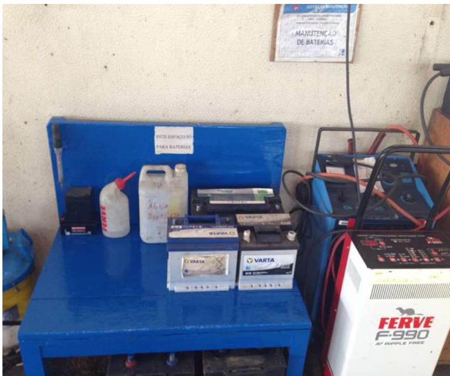
Fotografia 26 – Manutenção das baterias
