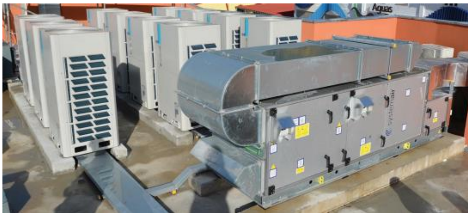
Figura 2.1 – Exemplo de uma zona técnica de um sistema centralizado (Climacer, 2023).
