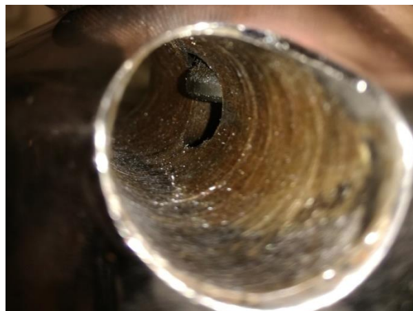
Figura 12 – Interior desgastado da peça a substituir
