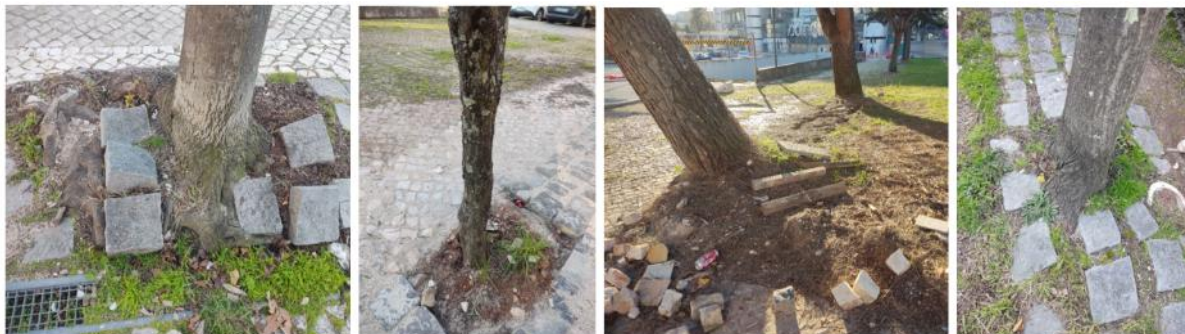
Figura 3.10 - Raízes expostas e interação com a calçada no Jardim da Solum (2024). Fotografias da autora.
