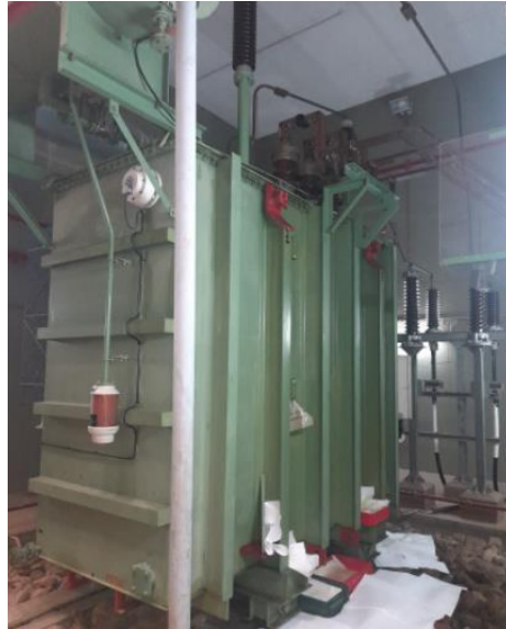
Figura 25 - Transformador do G6 do A.H.Belver.
