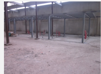
Fig. 26 Estructura metálica del cubículo de la Incubadora. Fotografía de autor.
