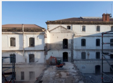
Fig. 58 Destrucción del ala. Fotografía sacada de Tabakalera.tumblr.com.
