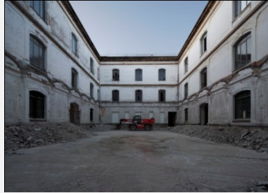
Fig. 55 Destrucción de la cubierta del patio. Fotografía sacada de Tabakalera.tumblr.com.
