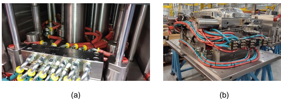
Figura 47 - Exemplos de ligações por mangueiras: (a) – ligações dos circuitos de refrigeração nos elementos de extração (levantadores e barras extratoras); (b) – ligações dos circuitos de refrigeração no exterior do molde.
