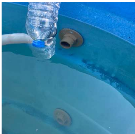
Figura 64 - Mangueira para captação de água superficial.
