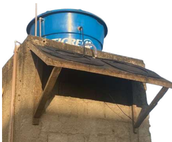
Figura 48 - Solar térmico construído na habitação.
