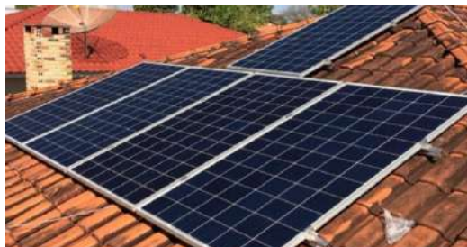
Figura 13 - Painéis Solares Fotovoltaicos para produção de energia elétrica.
