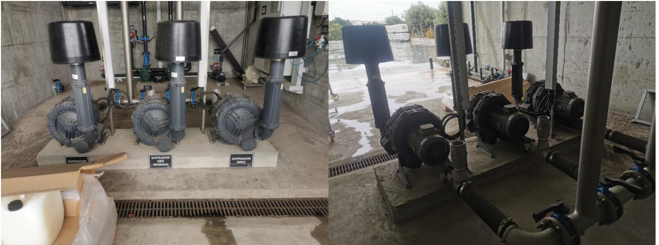
Figura 20 - Sopradores dos SBRs 1 e 2 e de reserva, vista frontal (à esquerda) e vista do fundo (à direita)
