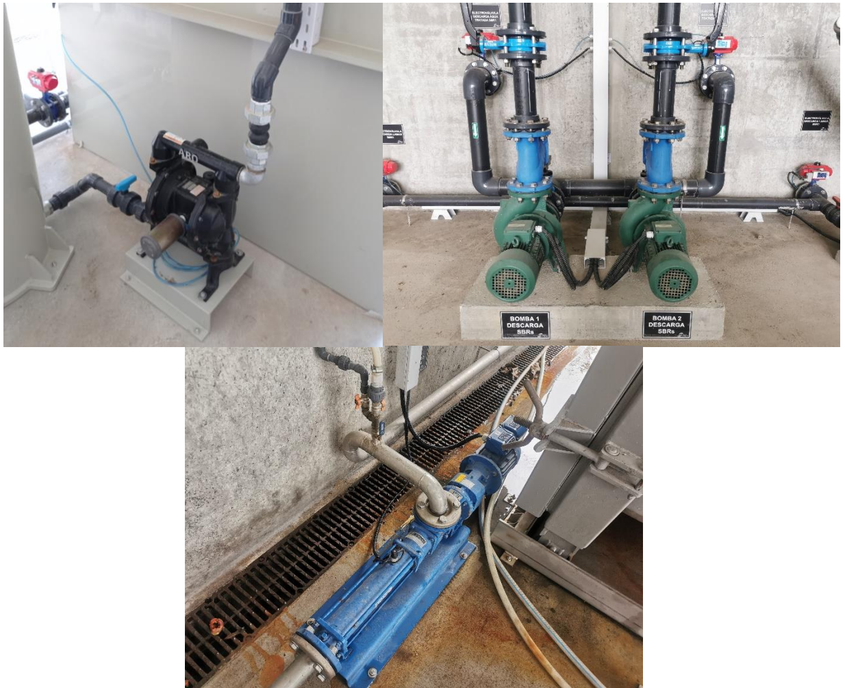
Figura 24 - Exemplos de bombas instaladas para a transferência de efluente entre as diferentes etapas; Bomba pneumática de lamas (à esquerda), bombas centrífugas de descarga dos SBRs (à direita) e bomba centrífuga da desidratação de lamas (ao fundo)
