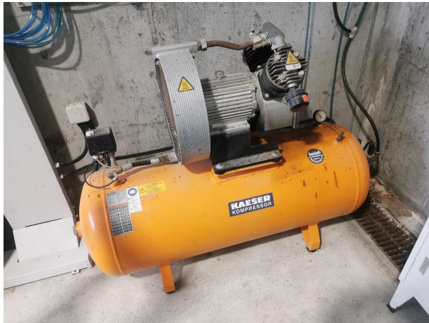
Figura 27 - Compressor abastecedor de todo o sistema de ar comprimido
