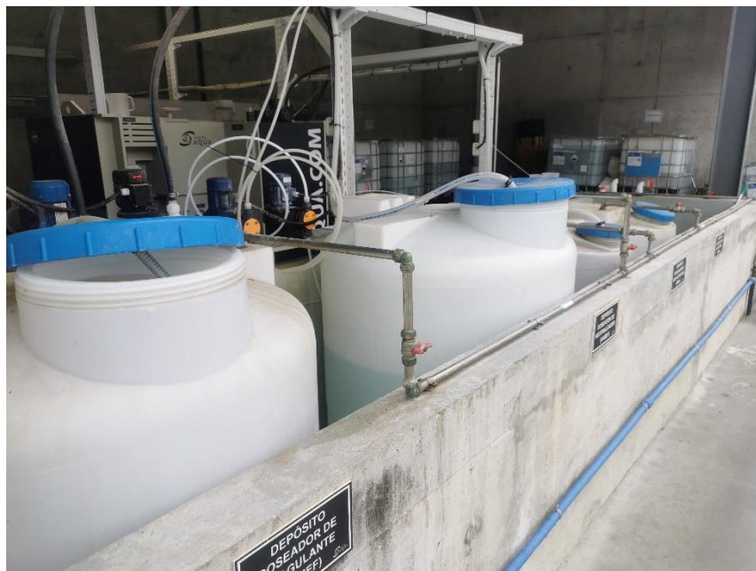
Figura 25 - Depósitos de produtos químicos para os SBRs e VAMEF
