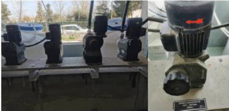
Figura 6 – Bombas doseadora utilizadas na ETAR para doseamento auxiliar de produtos químicos (à esquerda), regulação de bomba doseadora (à direita)
