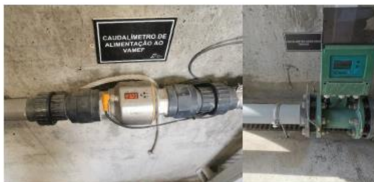
Figura 4 – Caudalímetro à entrada da ETAR (à esquerda), caudalímetro à saída da ETAR (à direita)
