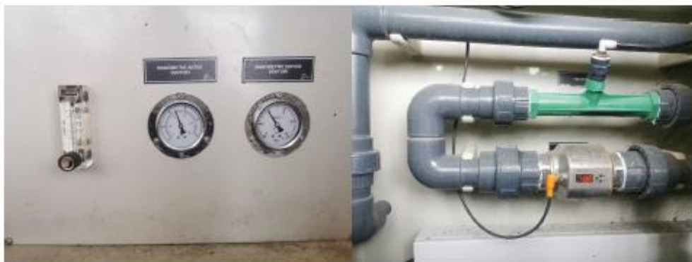
Figura 5 - Caudalímetro da entrada de ar comprimido na recirculação e manómetros para a medição da pressão antes e depois do Venturi (à esquerda), caudalímetro da entrada de efluente recirculado no equipamento VAMEF
