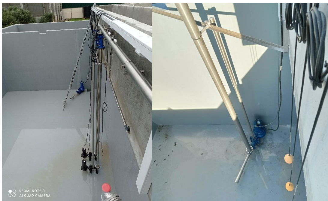
Figura 23 - Misturadores presentes nos tanques de homogeneização
