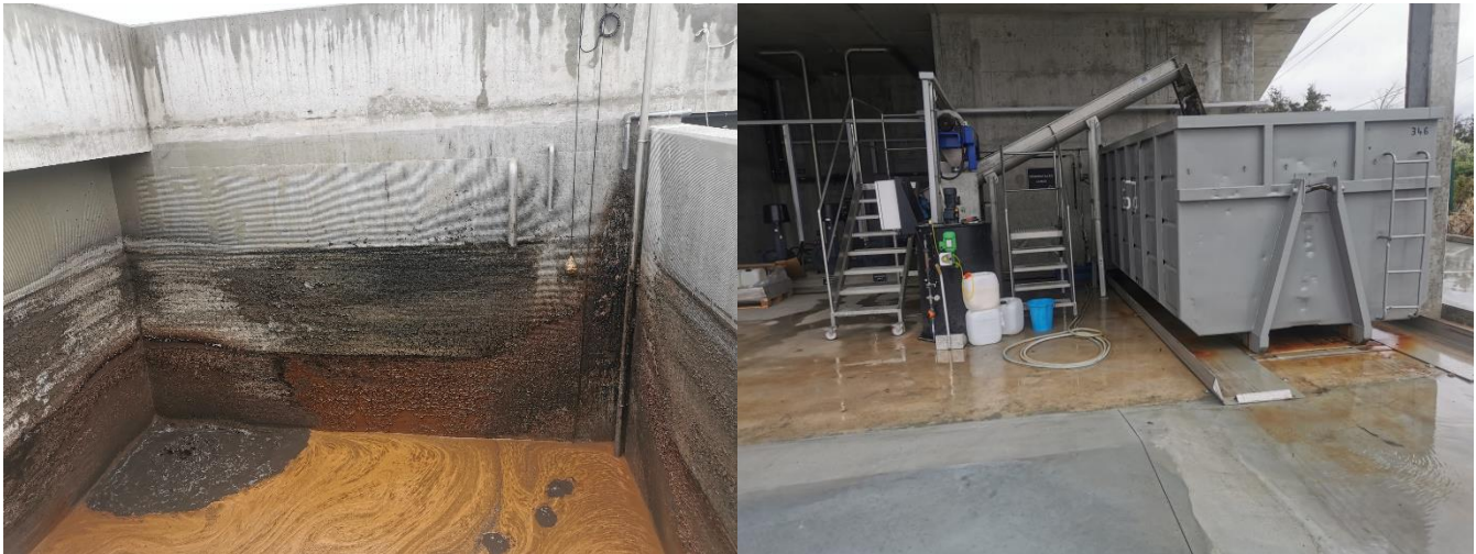
Figura 19 - Espessador (à esquerda) e Estação de desidratação de lamas com centrífuga e contentor de lamas desidratadas (à direita)
