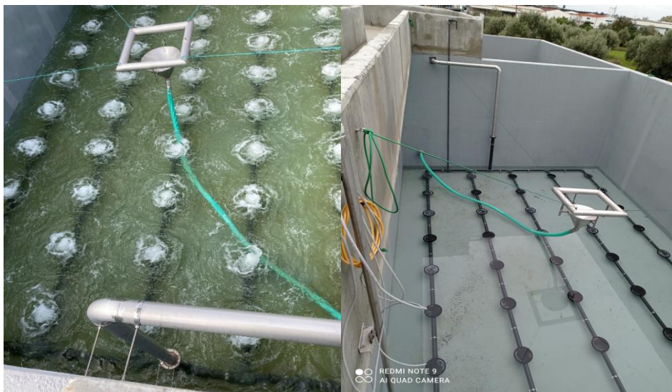
Figura 22 - Redes difusoras dos SBR1 e SBR2
