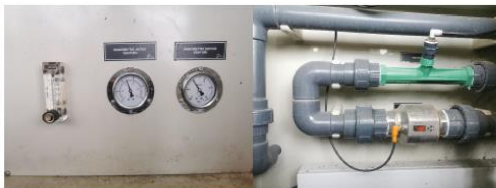
Figura 5 - Caudalímetro da entrada de ar comprimido na recirculação e manómetros para a medição da pressão antes e depois do Venturi (à esquerda), caudalímetro da entrada de efluente recirculado no equipamento VAMEF
