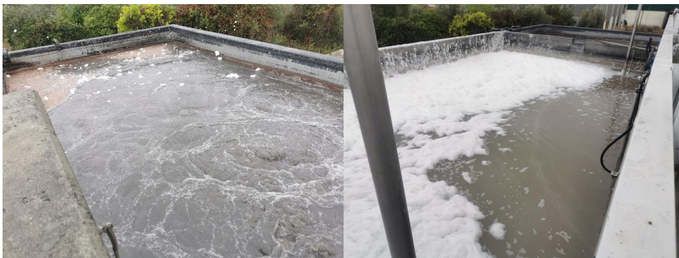
Figura 13 - Tanque de Homogeneização Primária (à esquerda) e Tanque de Homogeneização Total (à direita)
