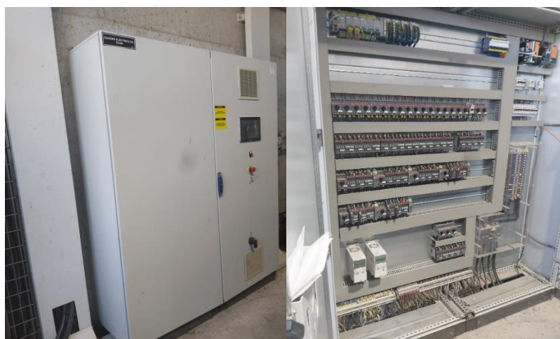
Figura 29 - Quadro eléctrico da ETAR fechado (à esquerda) e aberto (à direita)
