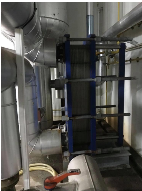
Figura 13 - Permutador de placas a glicol (Cofisa 2)
