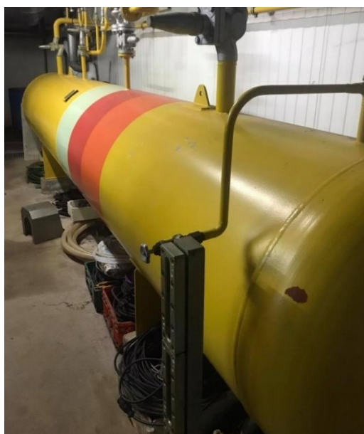
Figura 14 - Reservatório de líquido (Cofisa 2)
