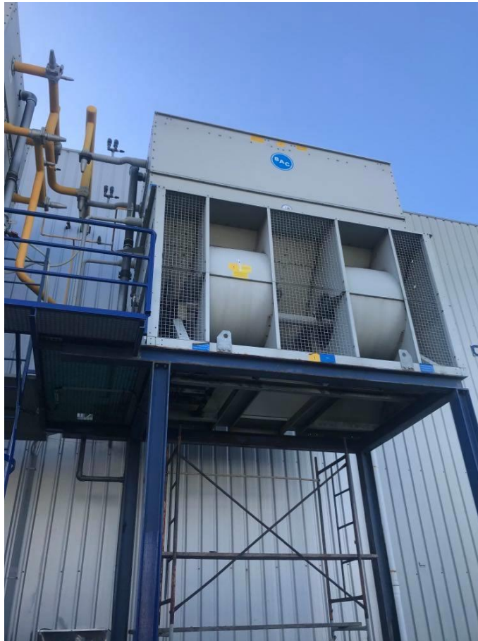
Figura 10 - Condensador evaporativo (Cofisa 2)
