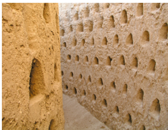
Fig. 32 Pombal em ruínas, Interior. Palazuelo de Vedija. (García, 2006)
