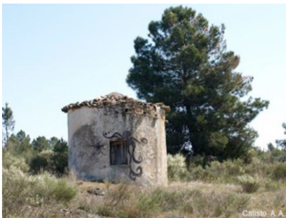
Fig. 37 Pombal em ruína . Carviçais, Torre de Moncorvo. (Calisto, 2009).
