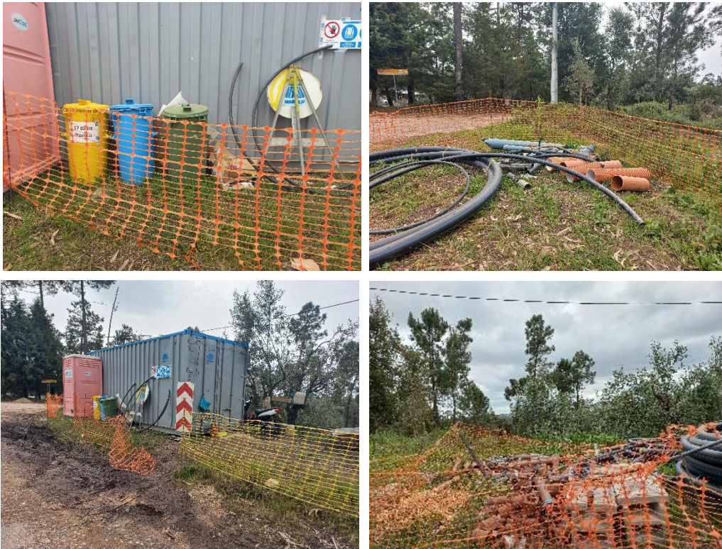
Figura 14- Irregularidades na zona de armazenamento temporário de RCD
