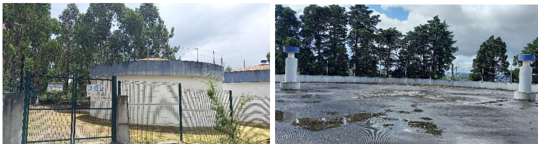
Figura 1 – Vedação e sistema de ventilação do reservatório de Santa Apolónia
