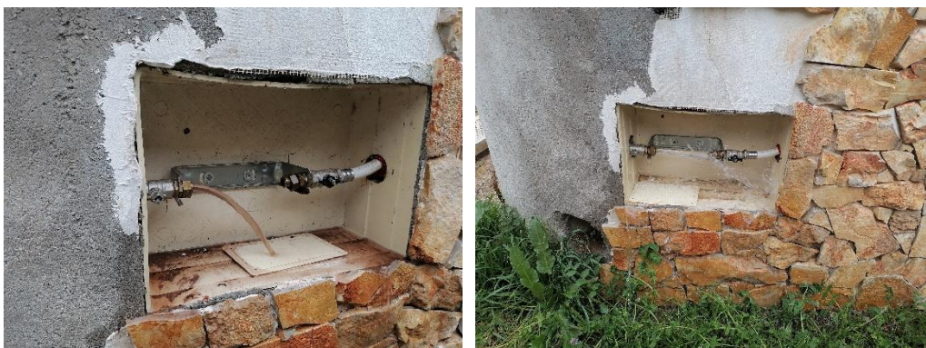
Figura 11 – Purga na rede através do local do contador de água
