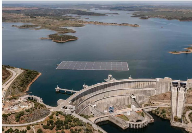
Figura 73: Parque fotovoltaico flutuante - barragem do Alqueva [20]
