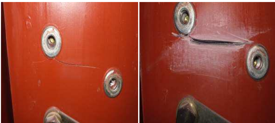
Figura 105: Fissuras nas bobinas MT
