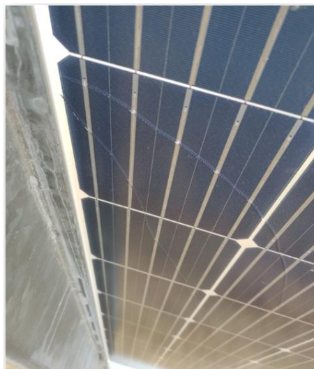
Figura 63: Fissuras no vidro inferior - módulo fotovoltaico bifacial
