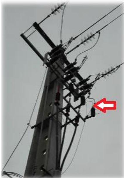
Figura 117: Apoio transição linha aérea – cabo subterrâneo com o DST com defeito
