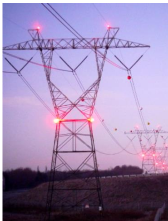
Figura 86: Apoios metálico com balizagem noturna [26]
