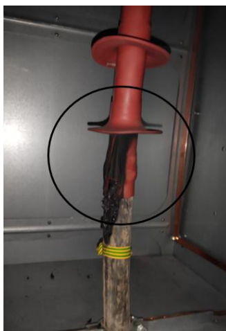
Figura 95: Caixa terminal cabo danificada – 30 kV
