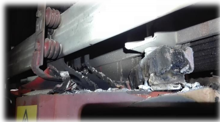
Figura 98: Transformador avariado - ponto estrela 690 V
