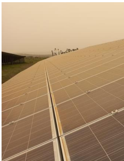
Figura 32: Sujidade nos Módulos Fotovoltaicos
