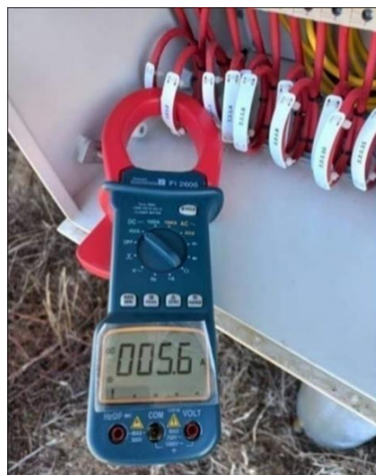
Figura 109: String da mesma caixa de junção não afetada pela sombra (5,6 A)
