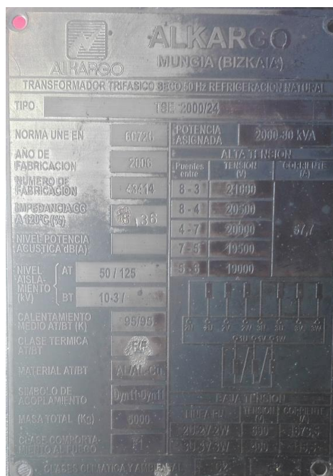
Figura 100: Chapa de características do transformador
