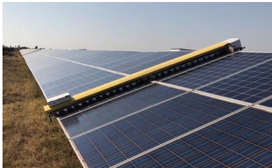
Figura 35: Robô de Limpeza - Exclusivo às Strings
