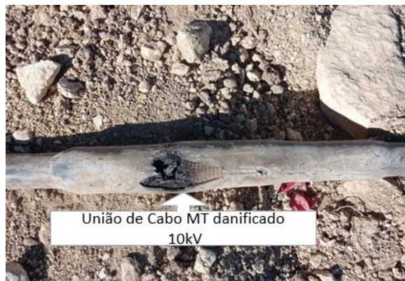
Figura 93: Cabo subterrâneo de média tensão de 10 kV
