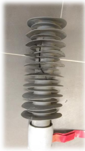
Figura 118: DST danificado com indicador de defeito visível
