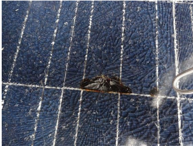
Figura 65: Quebra de vidro devido a um ponto quente no módulo [15]
