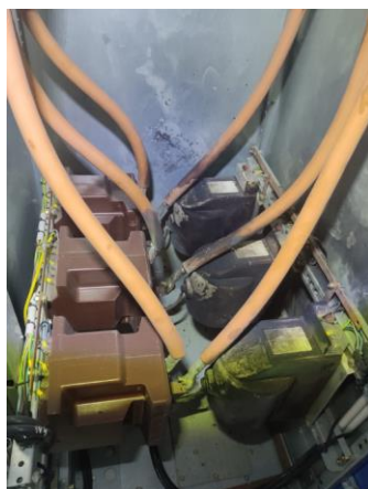
Figura 96: Transformador de corrente (TI) danificado – 15 kV
