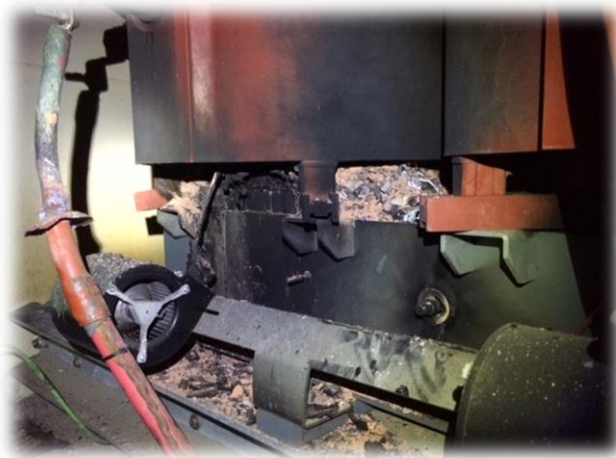
Figura 99: Transformador avariado - zona inferior das bobinas MT
