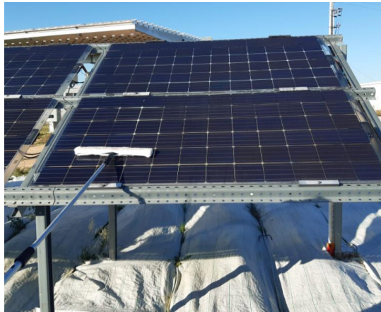
Figura 33: Sistema Manual de Lavagem – Módulo Bifacial
