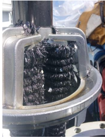
Figura 23: Íman da caixa multiplicadora colmatado de partículas metálicas
