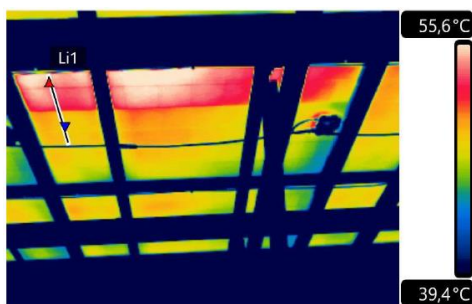
Figura 47: Imagem Termográfica - Identifica Díodos em Bypass
