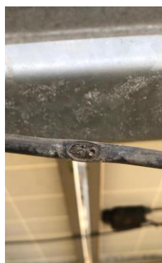
Figura 68: Defeito no isolamento - cabo CC
