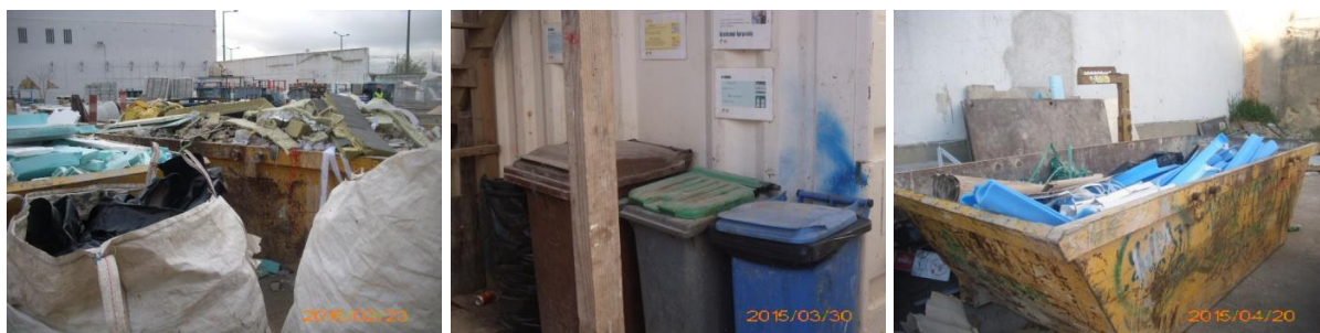
Figura 5.22 – Zonas de separação e armazenamento de resíduos.
