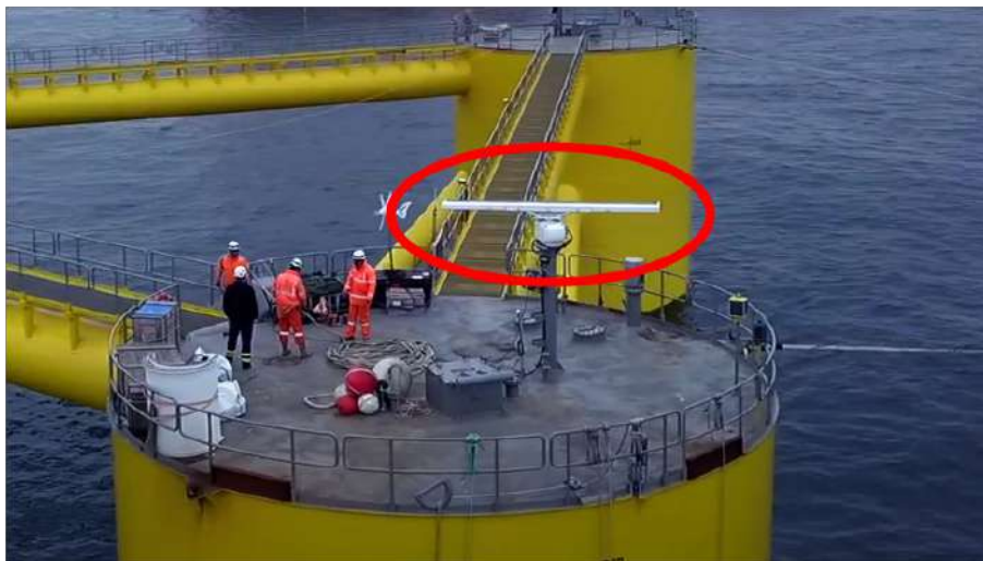
FIGURA 4.8: Sistema VTS instalado no projeto Winfloat (Fonte: (Windfloat Atlantic 2020)).
