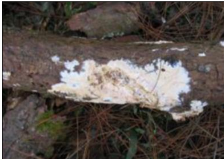
Figura 27 – Madeira atacada por fungos da podridão. [CORREIA, A.M. 2014];
