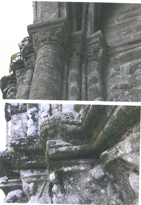
Figura 12: la colonización moderada, de líquenes endolitos aporta calidez al edificio (pátina biológica), sin embargo, las colonizaciones que forman una costra densa, además de retener humedad ocultan las formas y posibles lesiones de la fábrica. Las labores de mantenimiento son imprescindibles para mantener controlada la densidad de la colonización.
