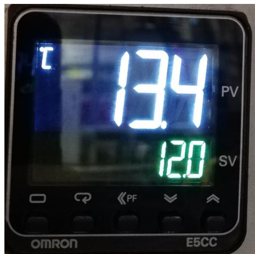
Figura 17 - Controlador E5CC em funcionamento
