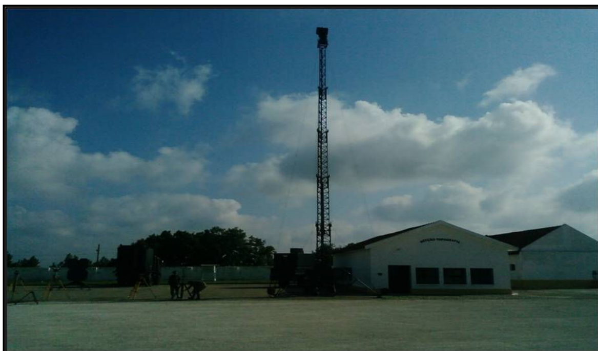
Figura 8: RLAM RATAC-S instalado no mastro de 17 metros.
