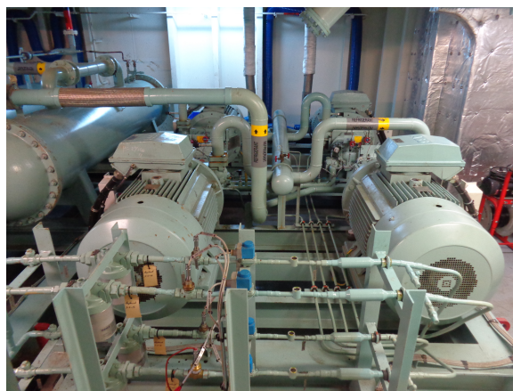
Figura 19 - Conjunto de 4 compressores Bitzer
