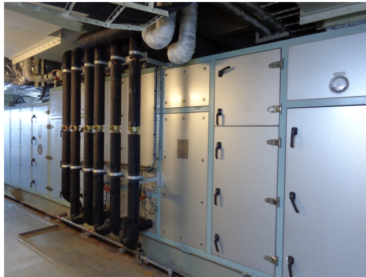
Figura 14 - Unidade de Tratamento do Ar
