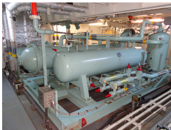
Figura 17 - Unidade de condensação. Vista do condensador.
