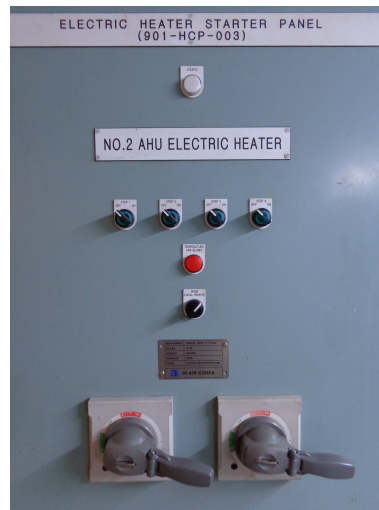
Figura 13 - Painel de controlo das resistências elétricas
