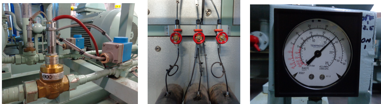
Figura 23 - Exemplos de instrumentação. Sensores de pressão, válvulas solenoide e manómetro de alta pressão
