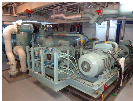
Figura 16 - Unidade de condensação. Vista dos compressores
