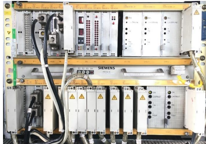
Figura 13 – Fotografia de uma Unidade Central de Comando (UCC)
