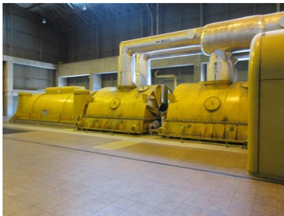
Figura 4: Turbinas de baixa pressão.
