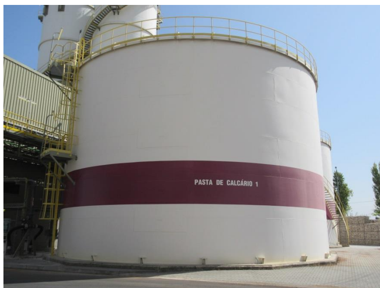
Figura 25: Tanque onde é armazenado o calcário em suspensão aquosa.
