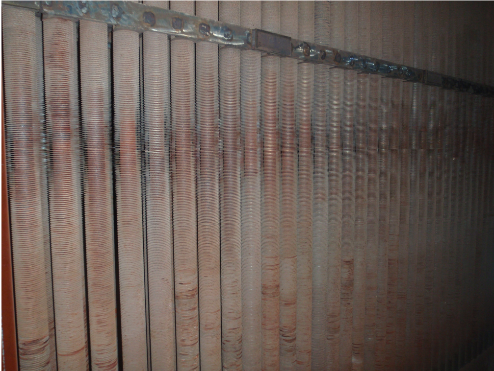
Figura 5-8 - Tubagens da caldeira
