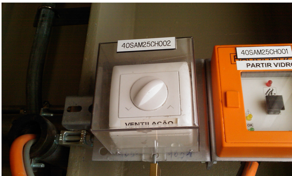
Figura 4-5 – Botoneiras 1 e 2 do sistema de ventilação na linha 25 do edifício da turbina do grupo 40
