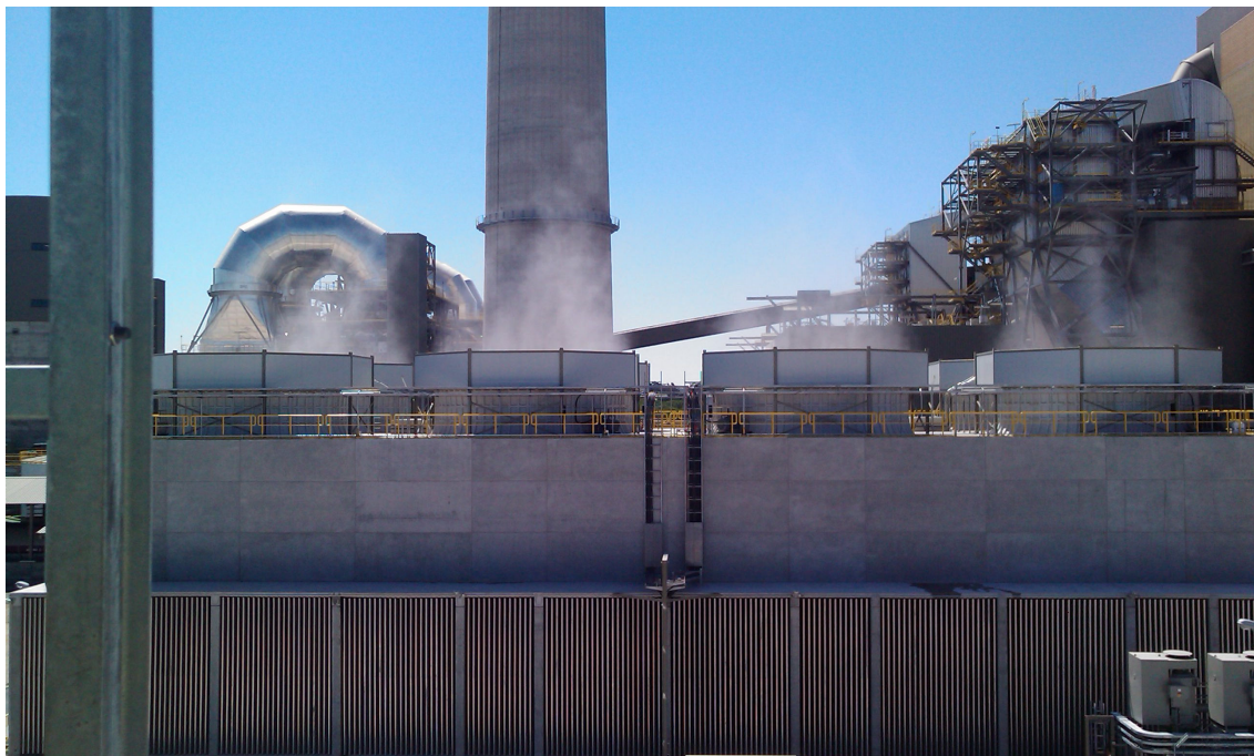
Figura 5-9 - Torre de refrigeração forçada do grupo 30
