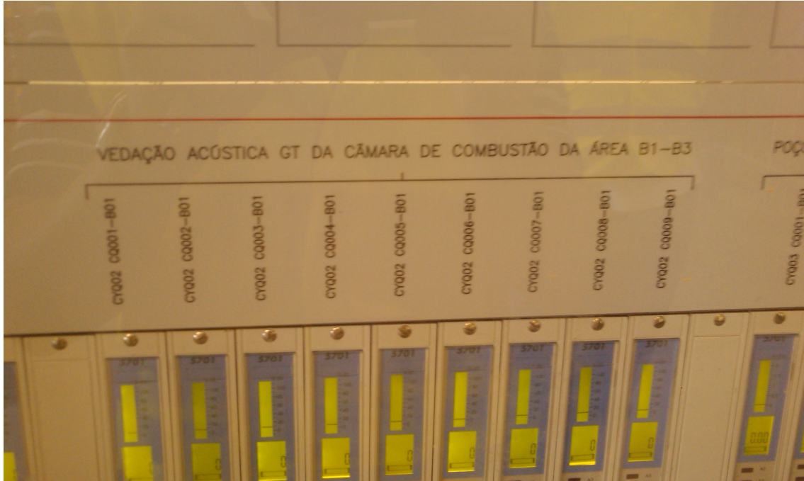
Figura 5-3 - Indicadores visuais dos transmissores de vibrações da turbina a gás natural
