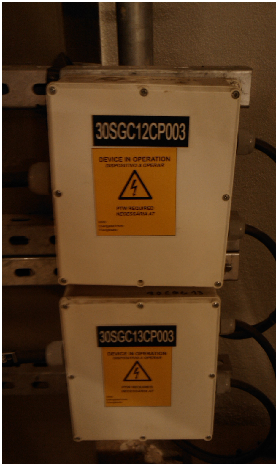
Figura 4-6 - Transmissores de pressão do sistema de incêndio nas linhas 12 e 13 do grupo 30
