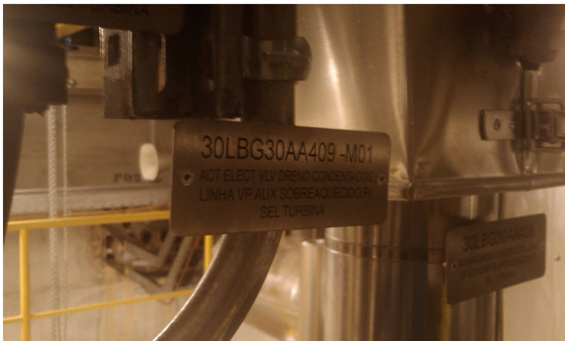
Figura 4-4 – Atuador elétrico da electroválvula 409 na linha 30 do sistema auxiliar de vapor da turbina a vapor do grupo 30
