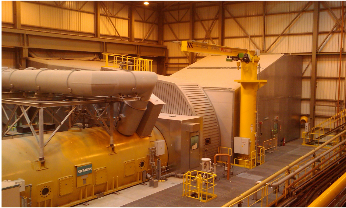
Figura 5-2 - Gerador 20kV, barras blindadas e enclausura da turbina a gás natural
