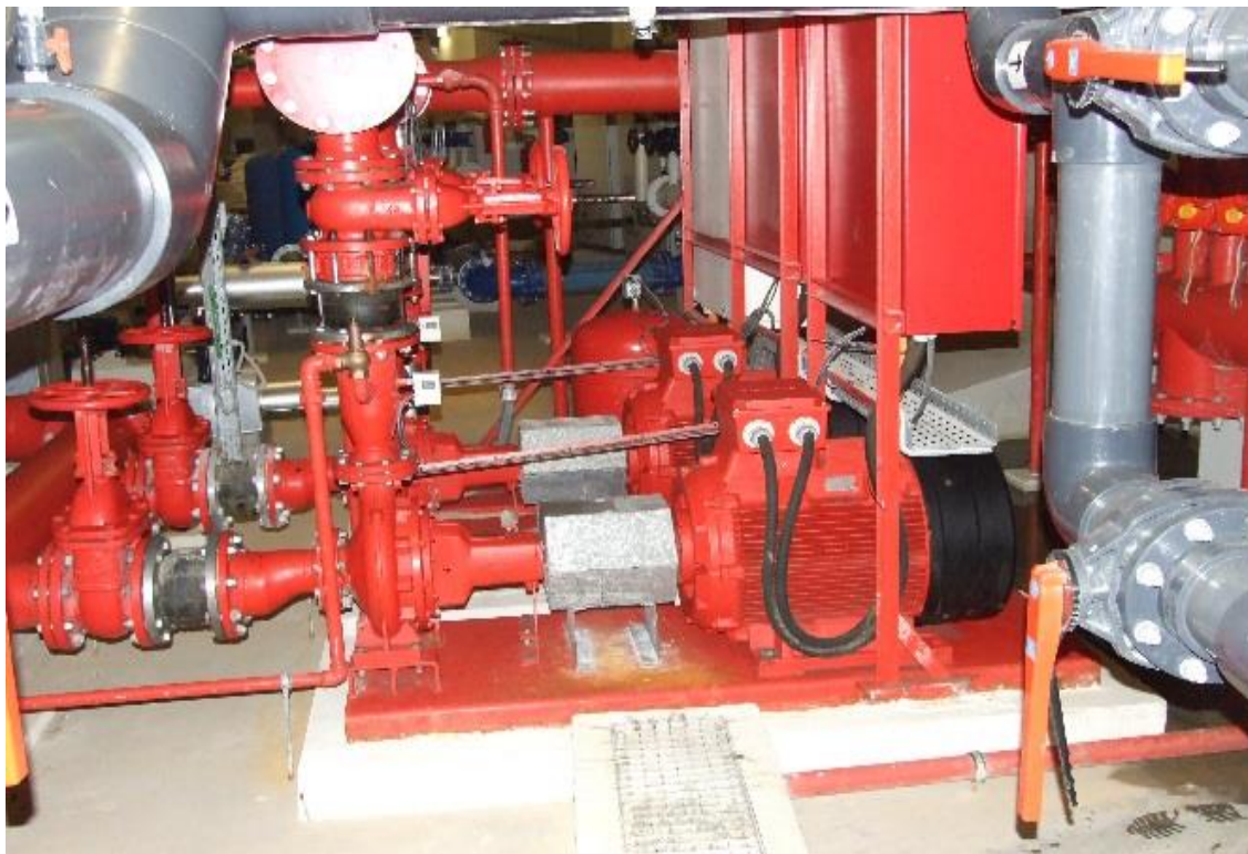
Figura 19 – Sistema de bombagens Rede de Incêndio.
