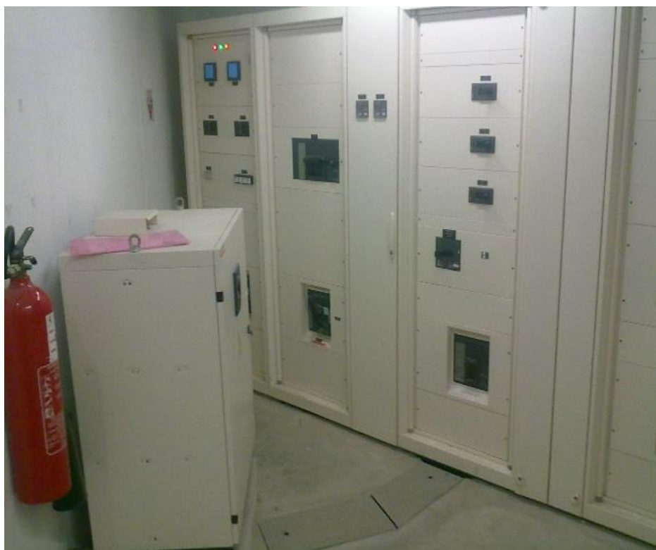
Figura 16 – QGBT do edifício e bateria de condensadores à esquerda.
