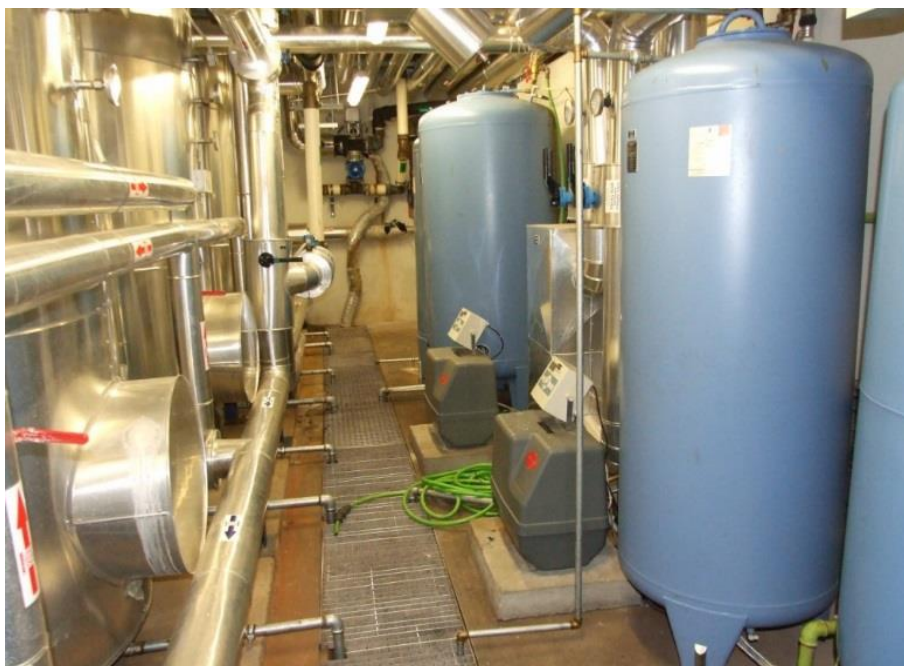
Figura 4 – Área técnica: Piso -1 Aqualuz Tróia.
