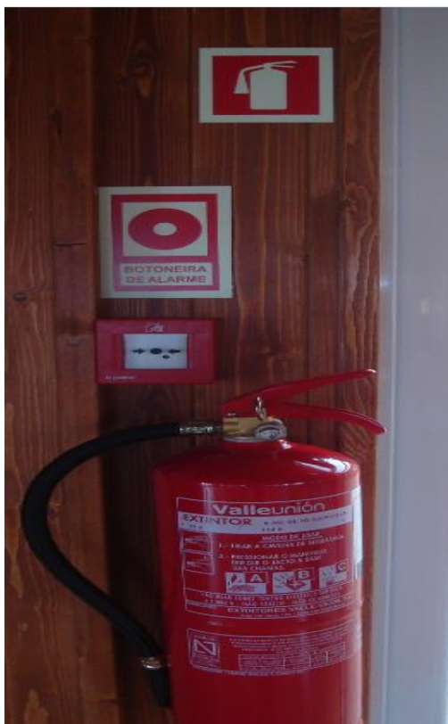
Figura 17 – Meios de Primeira Intervenção: Extintor.
