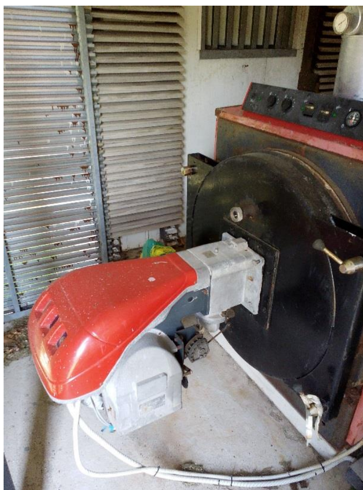
Figura 9 – Caldeira Roca existente.
