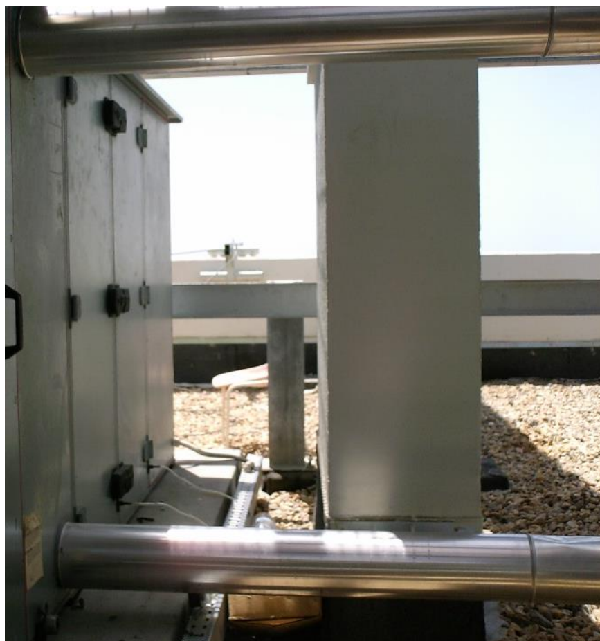
Figura 10 – UTAN existente na cobertura do Tróia Mar e tubagem das baterias (à direita).
