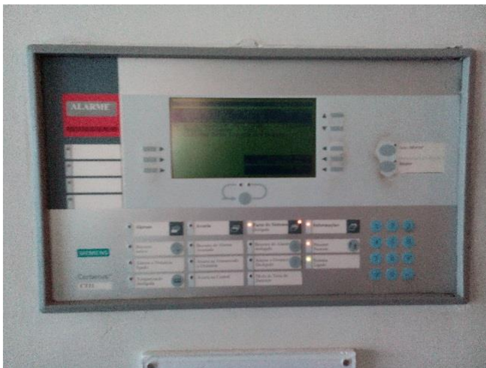
Figura 18 – Central de Detecção de Incêndios.
