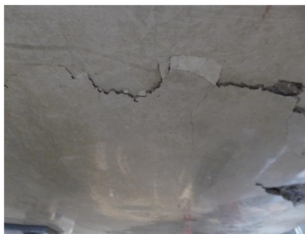
Figura 5.5 – Rotura por punçamento da laje LA1-LC45.
