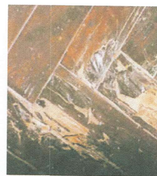
PAVIMENTO DANIFICADO POR HUMIDADE
