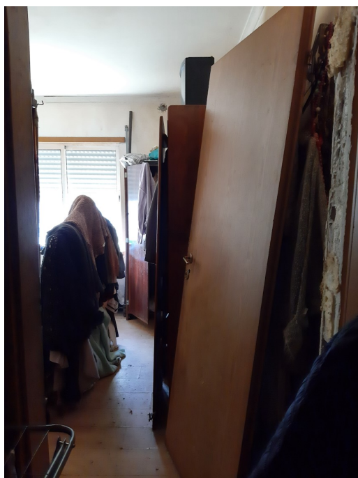
Figura 20 - Porta deteriorada (Fonte: Câmara Municipal de Grândola, 2024)
