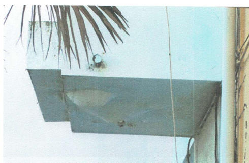
DESPRENDIMENTO E FALTA DE ADERÊNCIA
