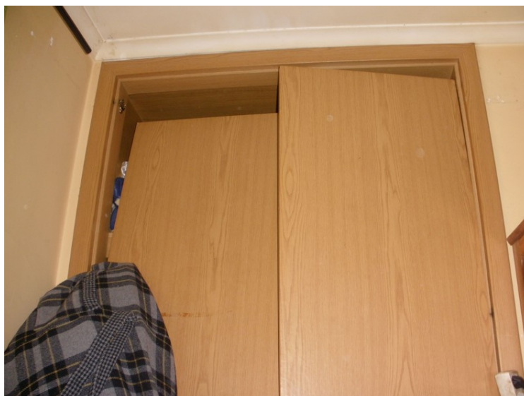
Figura 23 - Roupeiro deteriorado (Fonte: Câmara Municipal de Grândola, 2024)
