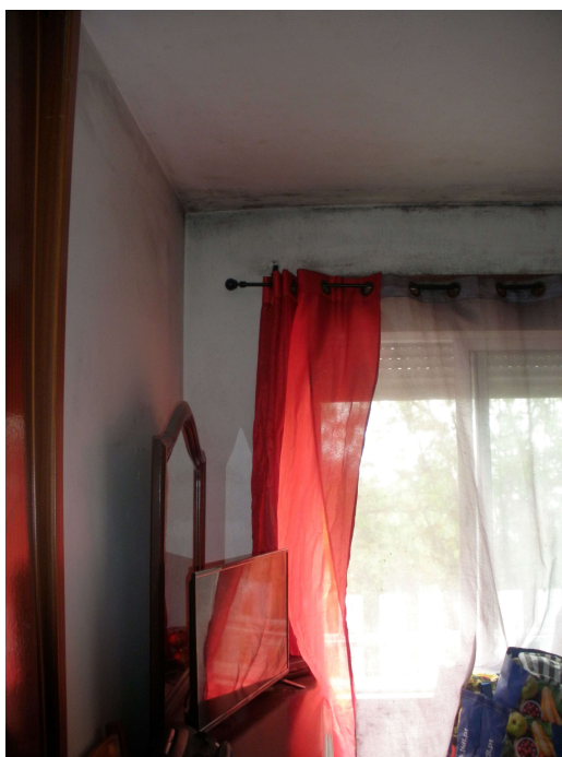
Figura 15 - Humidades, bolor (Fonte: Câmara Municipal de Grândola, 2024)
