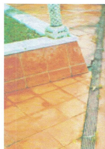
IRREGULARIDADES NO PAVIMENTO
