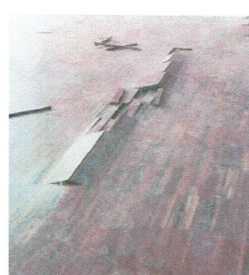
SOALHO EM MADEIRA COM PRESENÇA DE HUMIDADE
