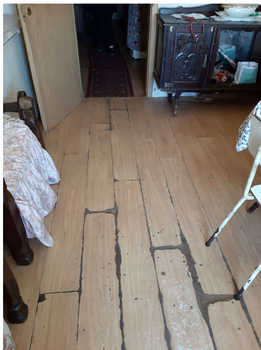
Figura 17 - Pavimento de madeira (flutuante) deteriorado (Fonte: Câmara Municipal de Grândola, 2024)
