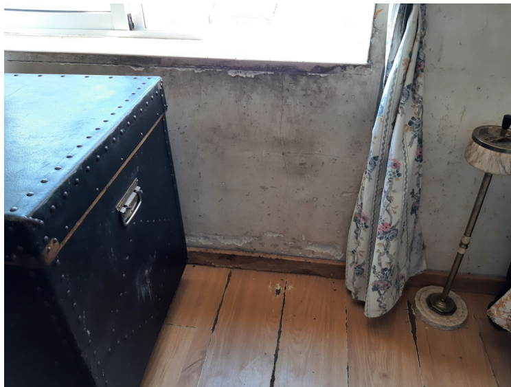
Figura 14 - Humidades, bolor e infiltrações (Fonte: Câmara Municipal de Grândola, 2024)
