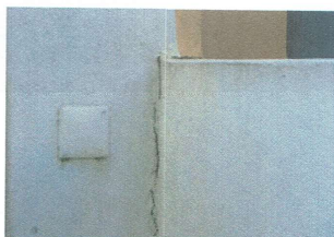
FENDA NO EXTERIOR DA HABITAÇÃO
