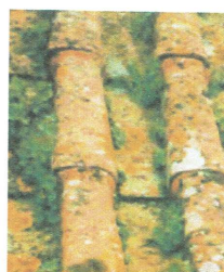
ACUMULAÇÃO DE FUNGOS
