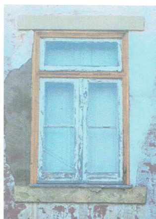
FALTA DE MANUTENÇÃO
