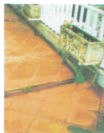
OBSTRUÇÃO DE ÁGUAS
