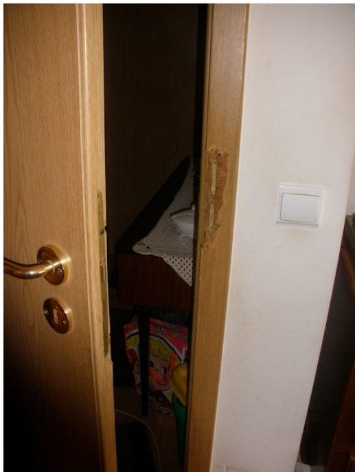
Figura 21 - Porta deteriorada (Fonte: Câmara Municipal de Grândola, 2024)
