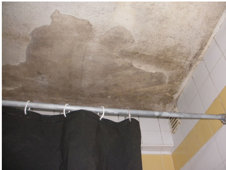
Figura 16 - Humidades, bolor (Fonte: Câmara Municipal de Grândola, 2024)
