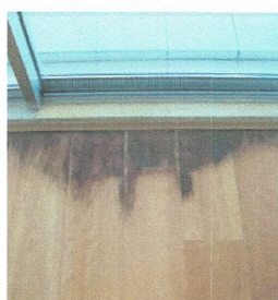
PARQUETE COM PRESENÇA DE HUMIDADE
