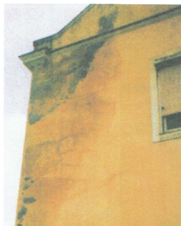
ACUMULAÇÃO DE HUMIDADE
