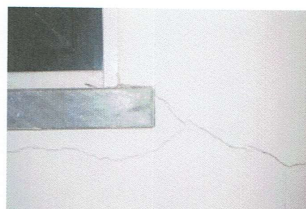
FISSURAS NO INTERIOR DA HABITAÇÃO
