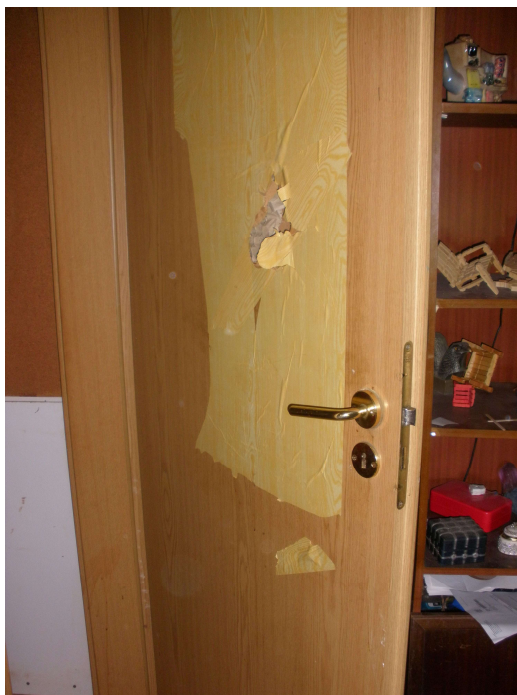
Figura 22 - Porta deteriorada (Fonte: Câmara Municipal de Grândola, 2024)
