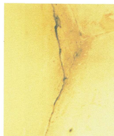
FALTA DE REPARAÇÃO DO ESTUQUE
