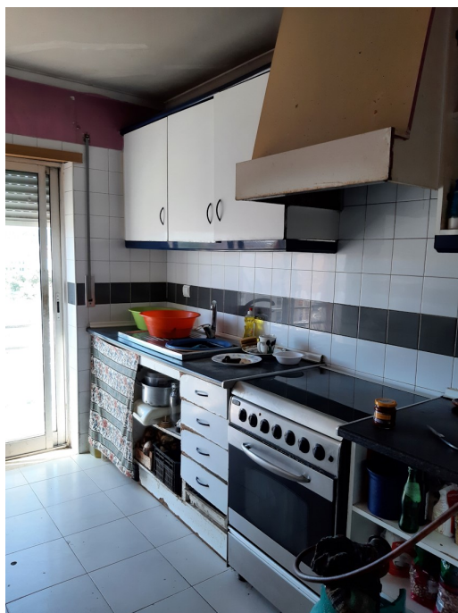
Figura 19 - Cozinha com móveis deteriorados (Fonte: Câmara Municipal de Grândola, 2024)
