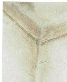
PAREDE COM SINAIS DE HUMIDADE
